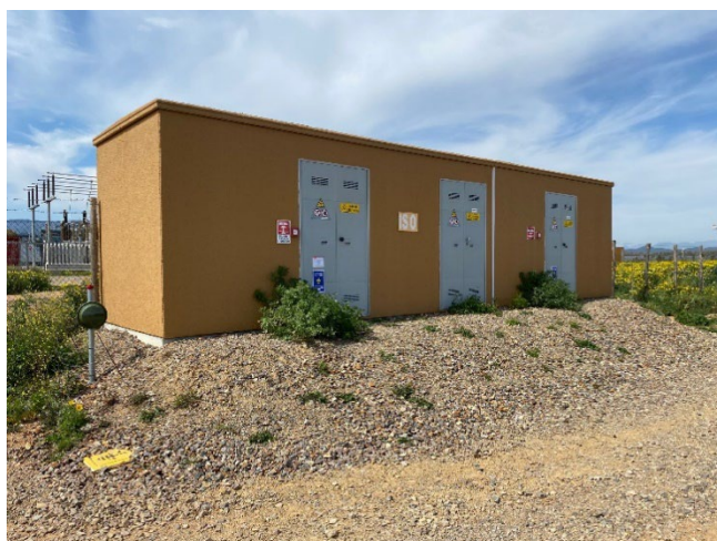
Immagine 3.2: tipologia cabina inverter
