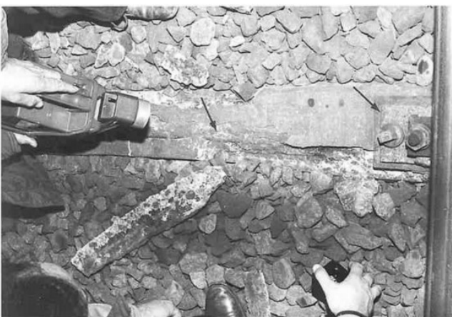
FIG. 14 - Intensa corrosione dei binari e delle traversine in c.a. (alla progressiva 9121), associata a modestissime percolazioni ad elevato contenuto salino e ad alto potere corrosivo. All'origine del fenomeno potrebbe esserci la presenza delle vicine masse gessose, i cui processi elettrolitici determinano campi elettromagnetici indotti, esaltati dal passaggio delle motrici elettrificate.
