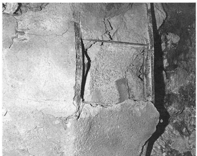
FIG. 15 - Deformazione delle centine alla progressiva 6650 m, in prossimità della faglia di cui al punto 9 in figura 3.
