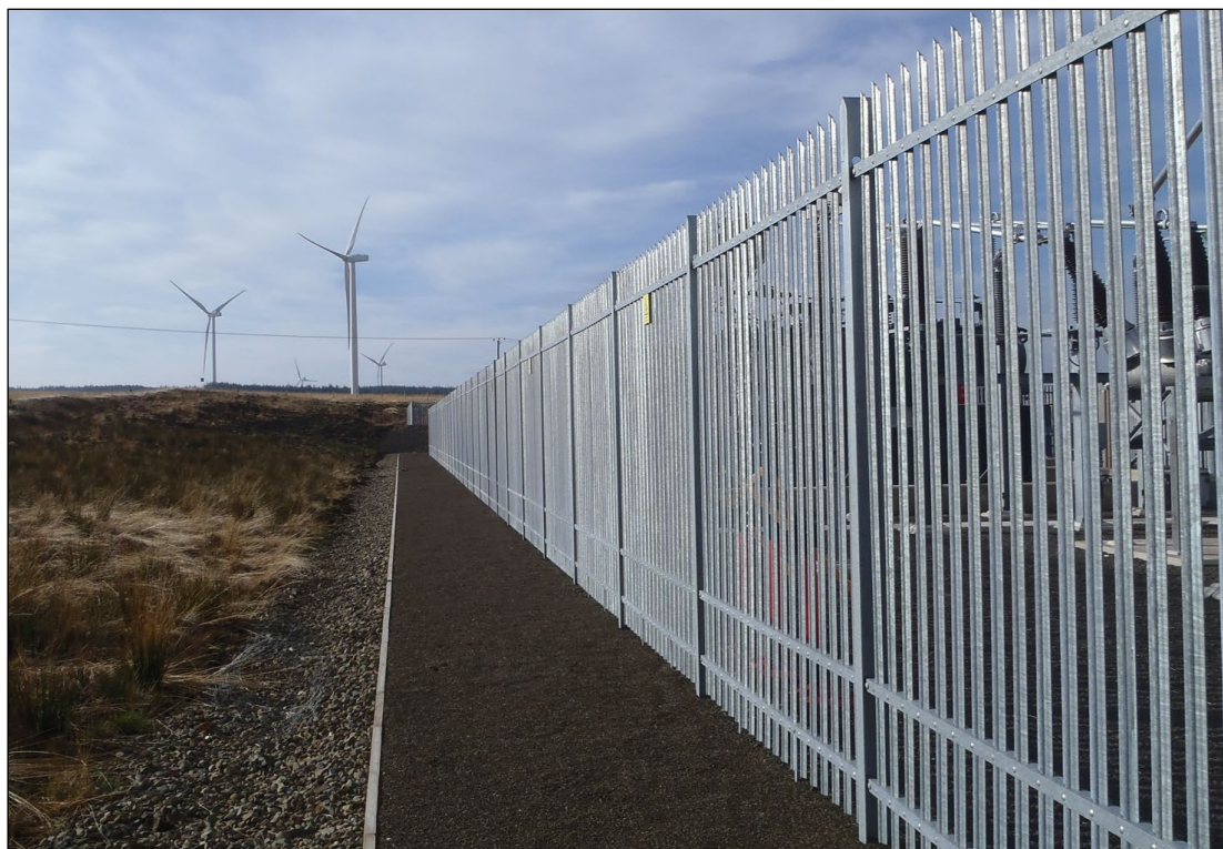
Figura 2-43: Tipica recinzione di sicurezza per stazioni elettriche.
