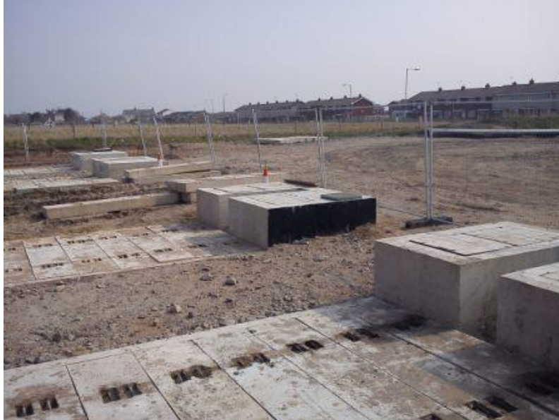
Figura 63: Foto esemplificativa chiusura buca giunti terra-mare, prima del riporto di terreno vegetale (Fonte OWC - ABL Group).
