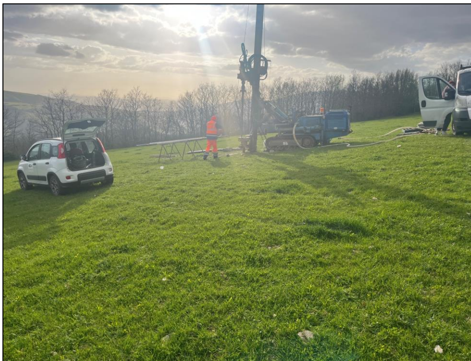
Figura 55: IMG_01, punto scatto in direzione dell'aerogeneratore FO01
