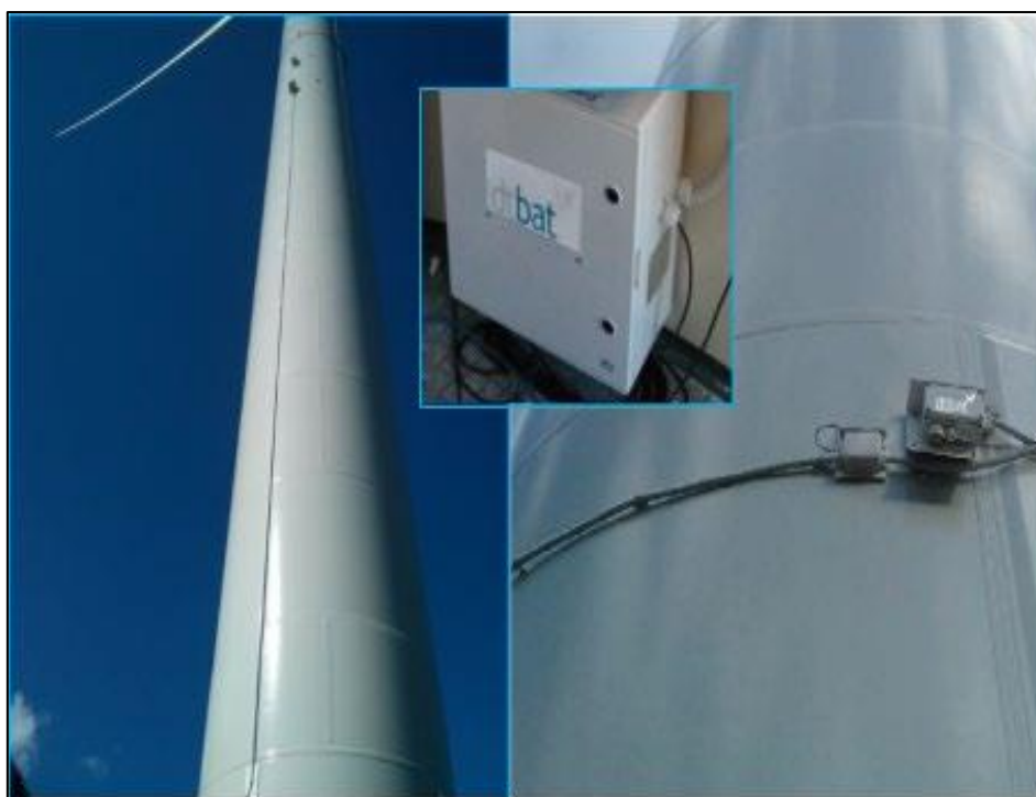
Figura 112: Esempio di sistema automatico installato su aerogeneratore al fine di limitare il rischio di collisione
