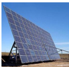
Impianto monoassiale (inseguitore di azimut)
