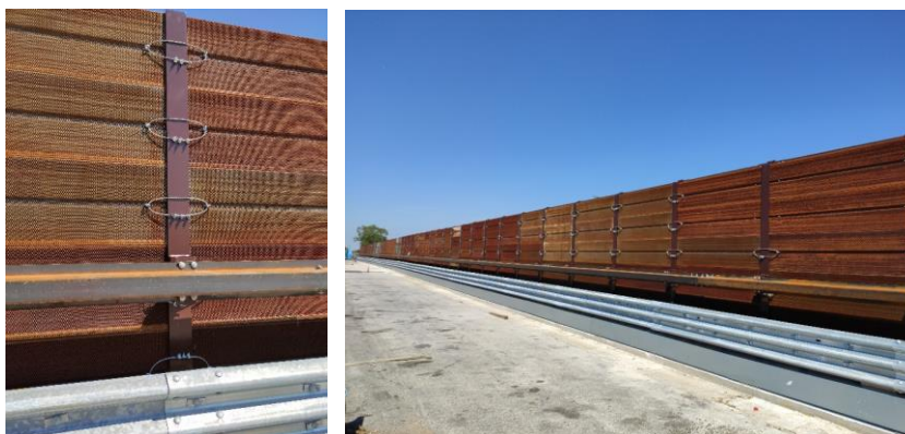
Figura 9-26 Immagine tipo di barriera acustica in acciaio corten con barriera stradale integrata
