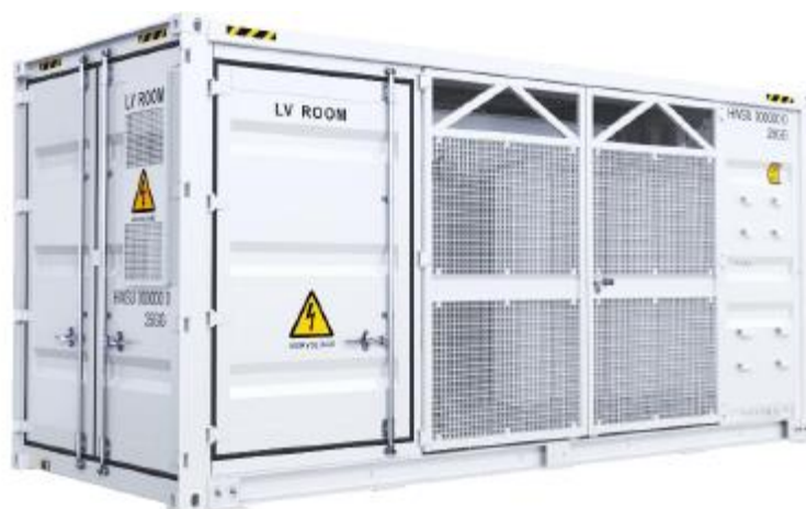
vista container di trasformazione
