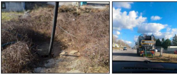
Fig. 9 A,B - Fuoriuscita di liquami con idrocarburi da tubazioni nel sottosuolo del COVA, e interventi di bonifica con aspirazione dei fluidi. (Foto A. Alberti)
