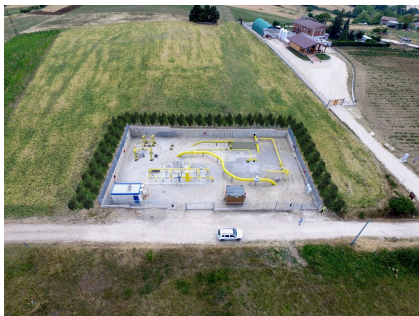
Figura 50 Stato futuro Impianto di Linea e Riduzione NODO 785 (P.I.D.I.), con mascheramento vegetazionale
