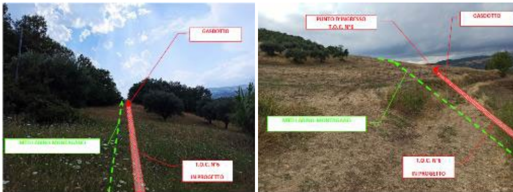
Figura 10 Superamento area in frana TOC n.6
