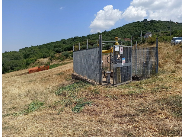
Figura 45 Stato attuale Impianto di Linea NODO 670 (P.I.L.)
