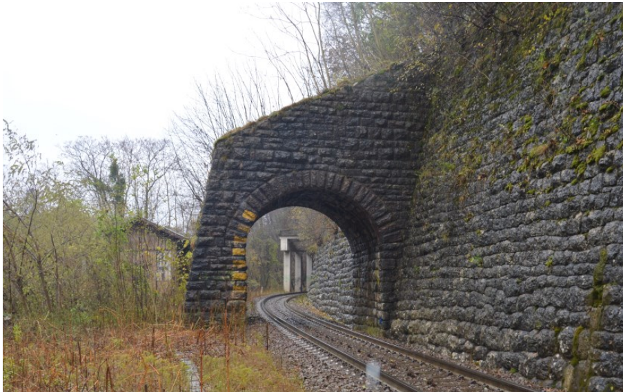
Figura 2: IV02 - Scivolo legnami 134+610 – Stato attuale
