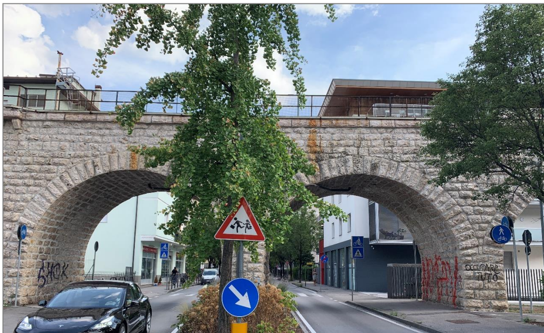
Figura 6 – VI01 – Viadotto Gocciadoro: vista lato nord dell'interferenza del Viadotto, nel tratto lato Trento, con via S. Pio X [foto da sopralluogo ITALFERR del 28 Luglio 2022]
