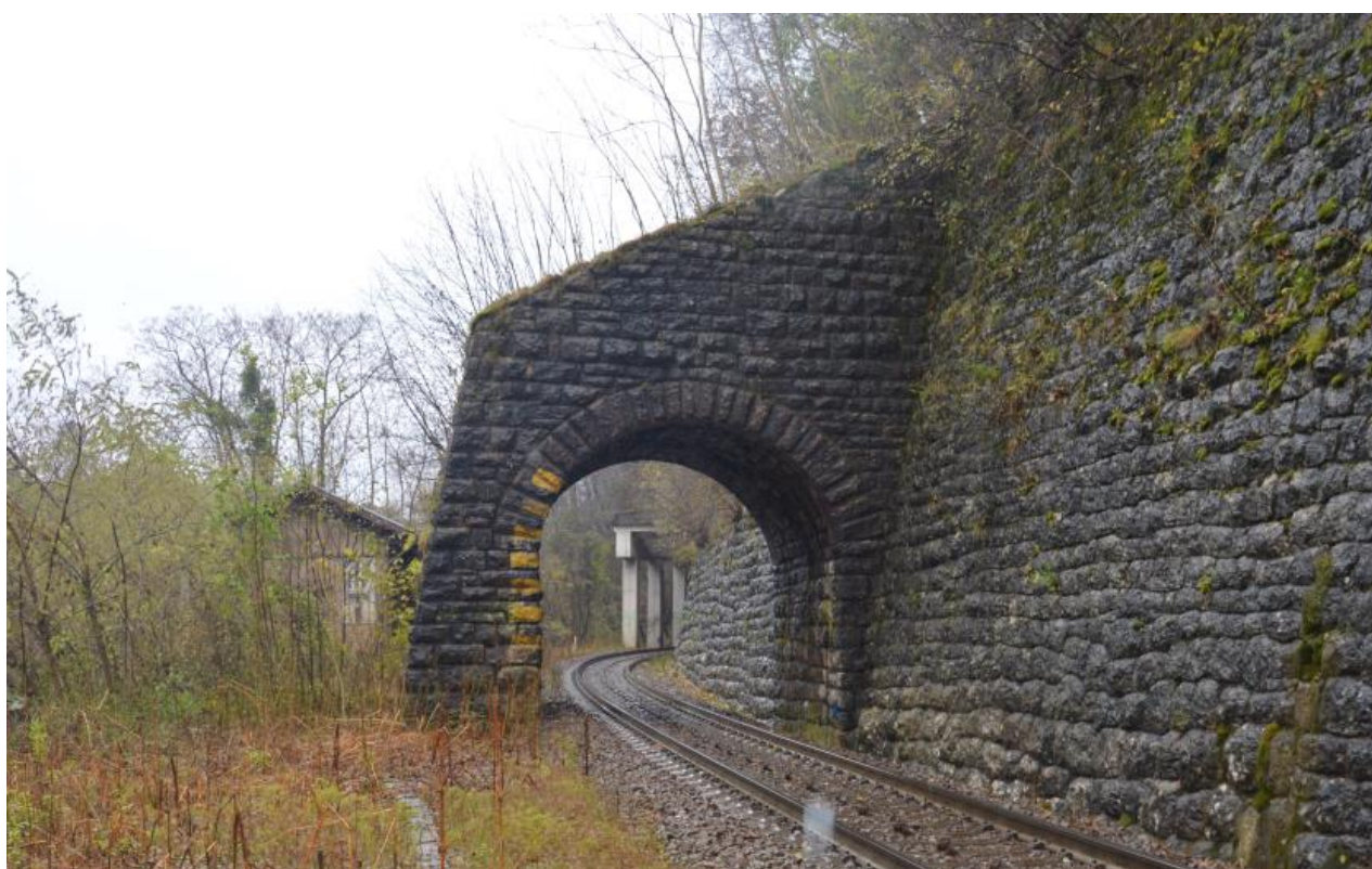
Figura 1: IV02 - Scivolo legnami 134+610 – Stato attuale
