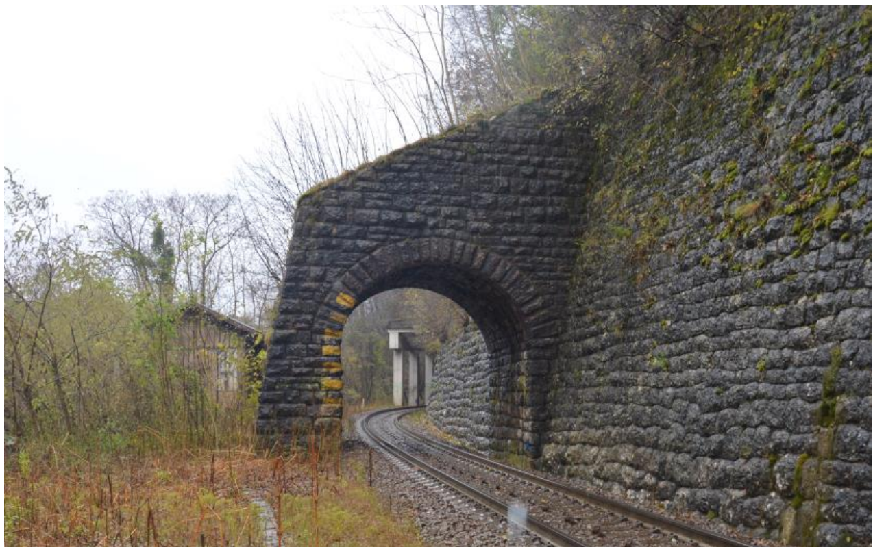
Figura 1: IV02 - Scivolo legnami 134+610 – Stato attuale
