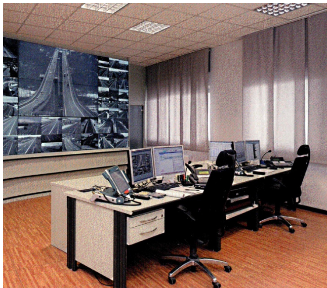
Fig. 3 – Esempio di allestimento Centro Operativo di Controllo
