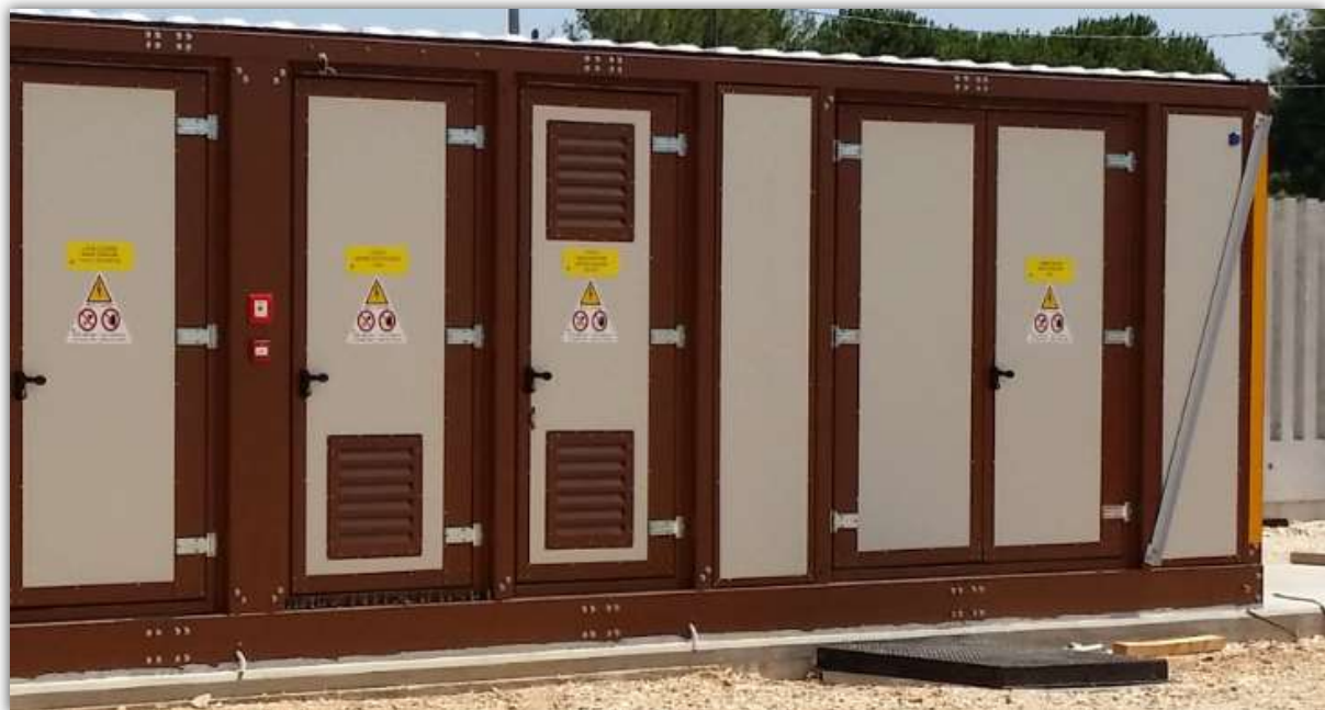
Fig. 1. Foto in opera di edifici tipo shelter.
