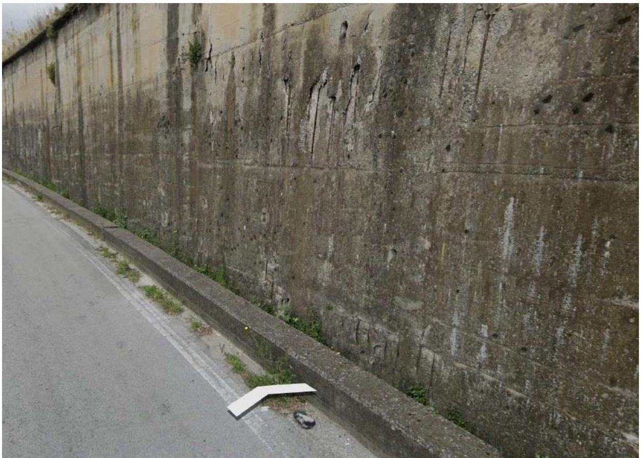
Figura 3.4: Tracce di scolo e quadro fessurativo in evidenza.
