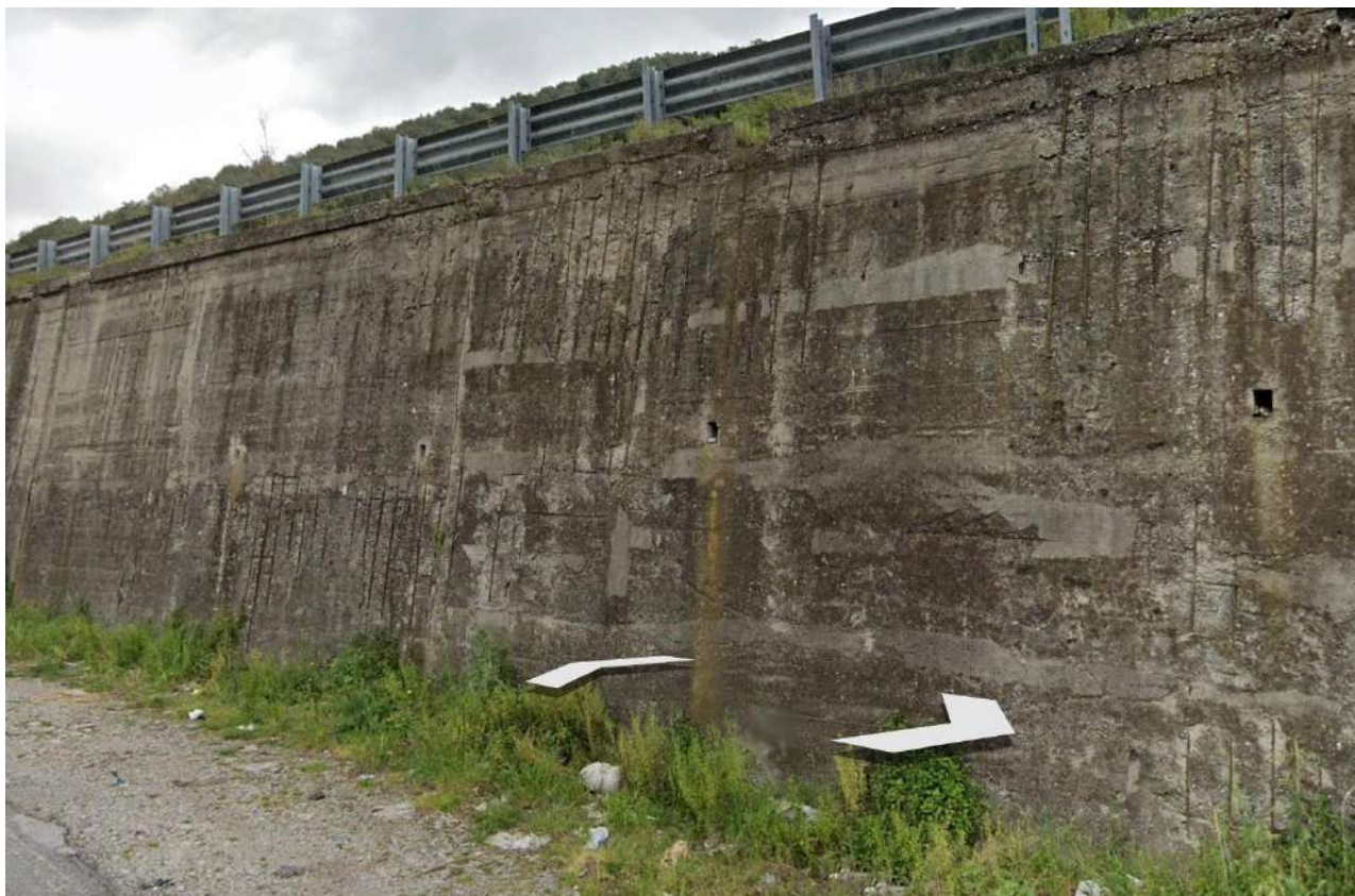
Figura 3.6: Tracce di scolo/umidità ed armatura priva di copriferro in evidenza.
