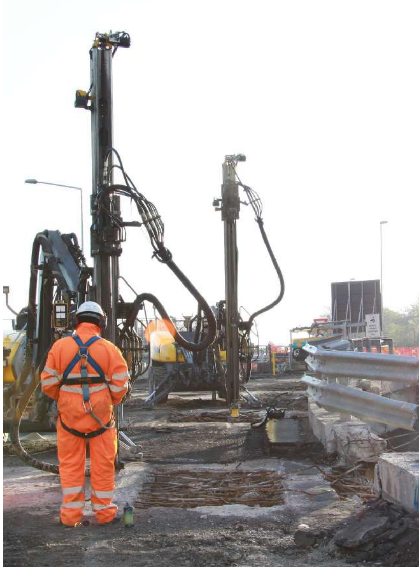
Foto 35.a. e "b". Perforazione fori da mina su arco e travi, con carri di perforazione idraulici radiocomandati.
