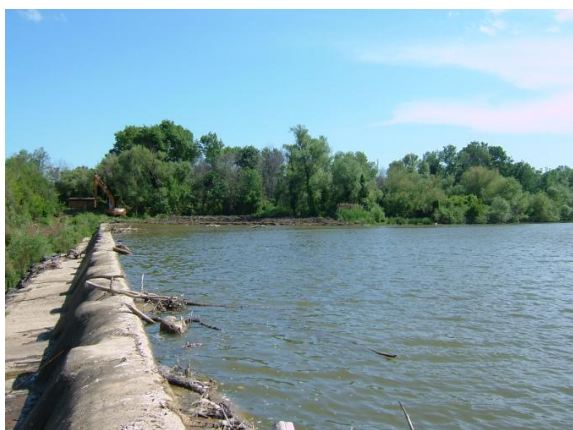
Foto F08 - Vista dello sfioratore e del percorso per l'accesso all'area di valle della diga (Foto 2007)
