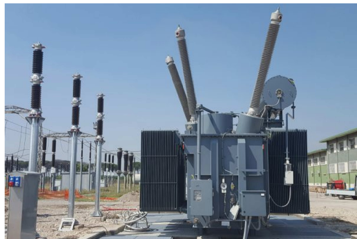
8 TRASFORMATORE 132 ±10X1.25%/30 KV YNd11
