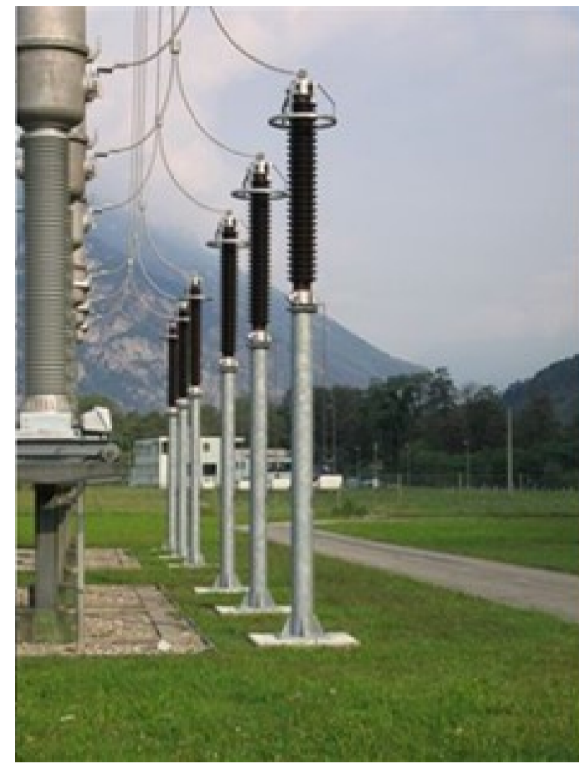
1 SCARICATORE DI SOVRATENSIONE AT
