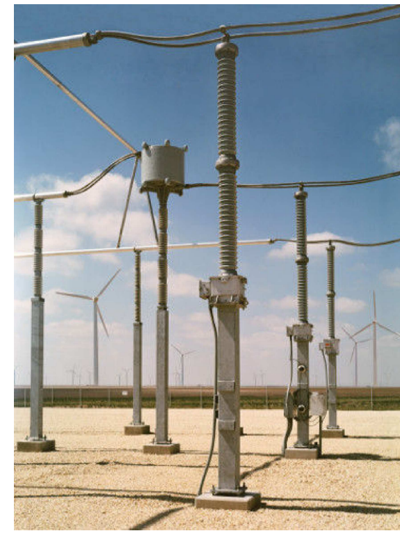
2 TRASFORMATORE DI TENSIONE TV
