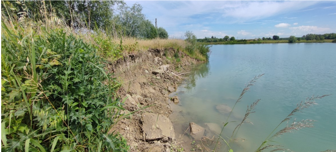
Figura 36. Ripresa fotografica di uno dei dissesti osservati lungo la sponda occidentale del lago nord di Cave Podere Stanga
