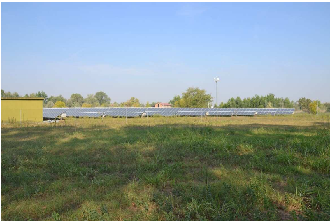
Figura 48. Impianto fotovoltaico a terra presente a 500 m N dal bacino lacuale nord. Fonte: rilievo fotografico ENVIarea (ottobre 2021)
