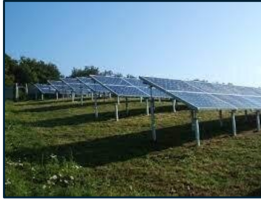
Figura 3.3.1.2.a Vista struttura fissa statica per moduli fotovoltaici
