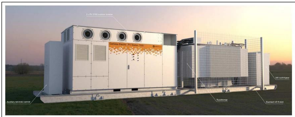
Figura 11 - ESEMPIO DI CABINA ELETTRICA (POWER STATION)
