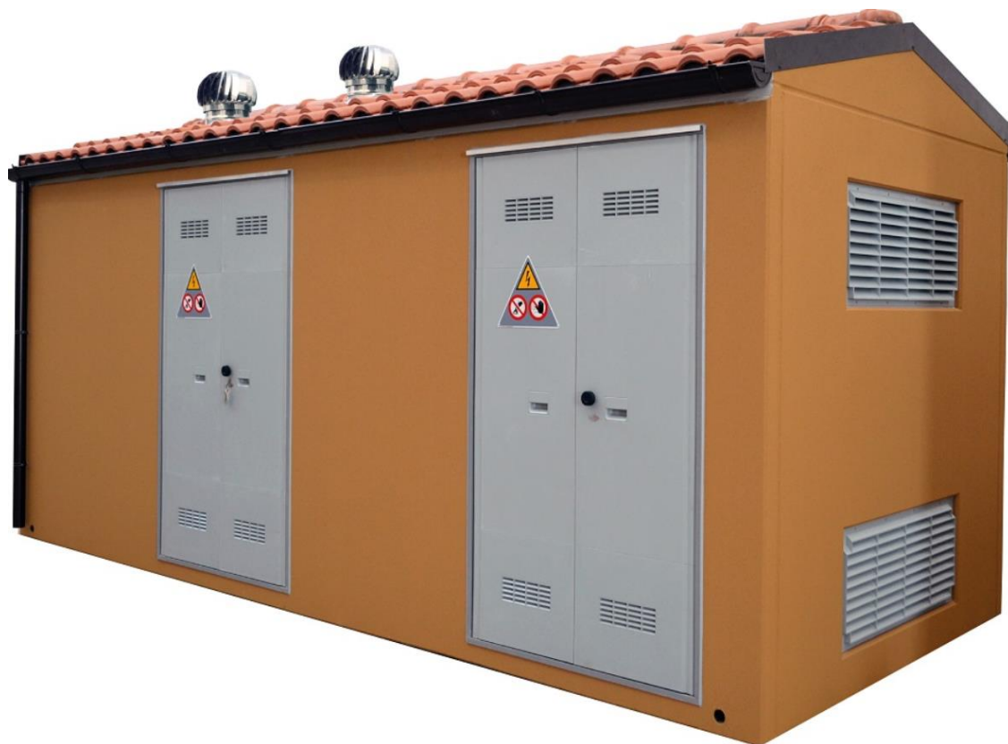
Fig. 11: cabina di raccolta – ESEMPIO
