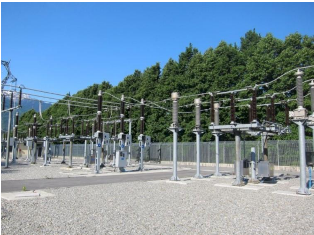
Fig. 30: esempio di sottostazione elettrica
