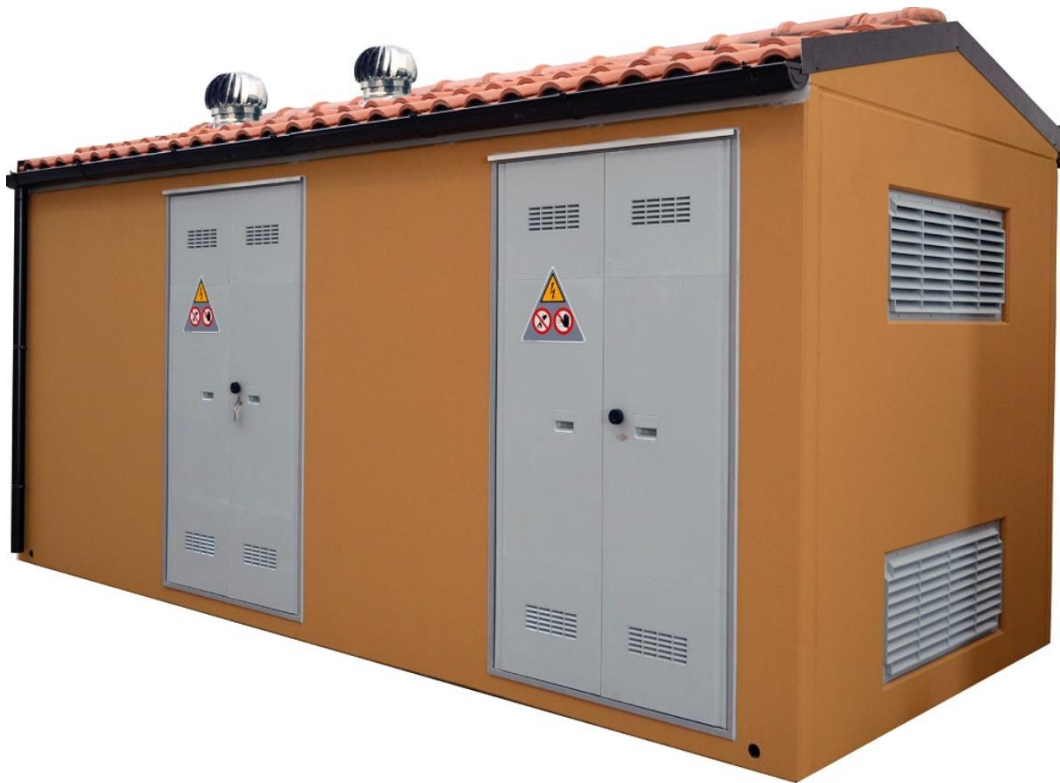
Fig. 5: cabina di raccolta – ESEMPIO
