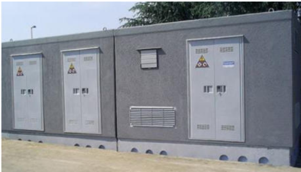
CABINA DI PARALLELO E CONTROL ROOM
