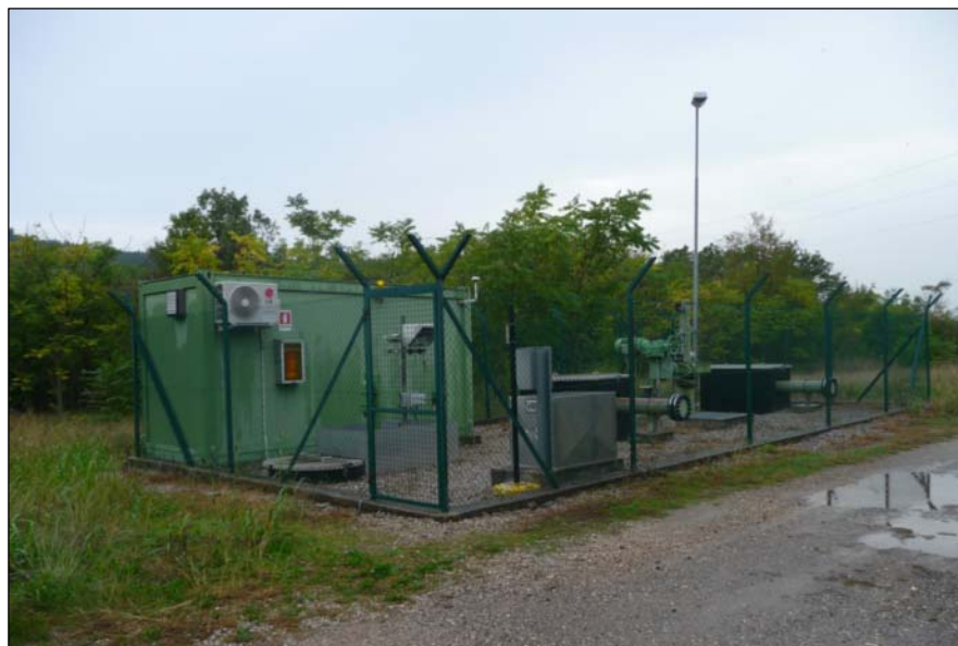
3 - Impianto di sezionamento per Oleodotto Transalpino (SIOT)
