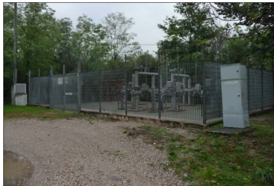
4 - Impianto SNAM Rete Gas
