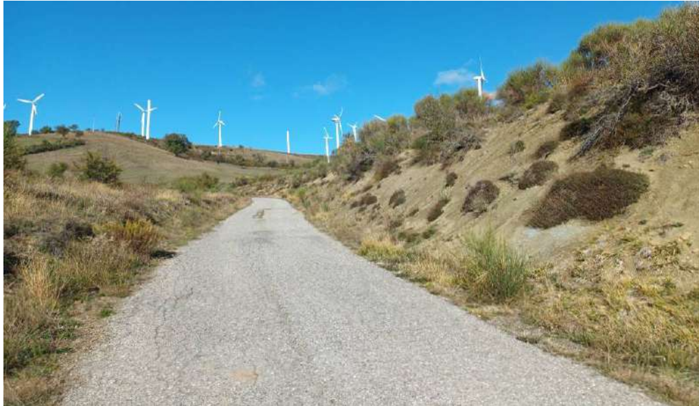
Foto n. 10 - Percorso flow line – scarpata con fenomeni di dilavamento e caduta di materiale
