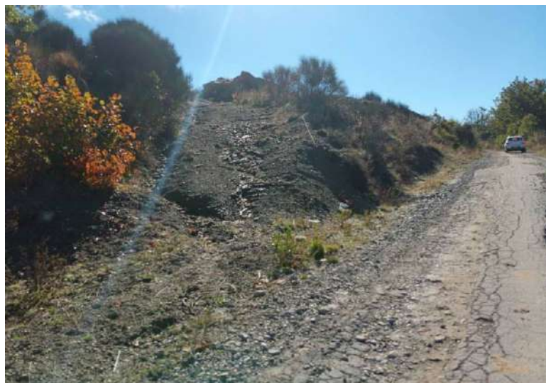
Foto 9 – Fenomeno di dilavamento superficiale
