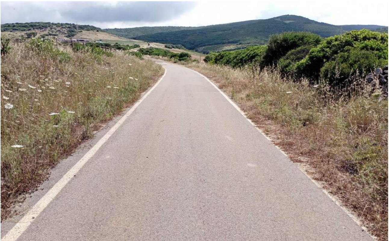
Figura 9.36 – Strada rurale bitumata di accesso alle postazioni eoliche del Cluster nord-ovest (direzione nord-ovest)
