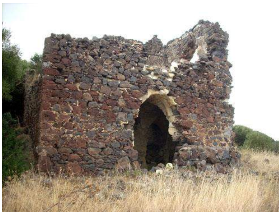
Figura 10.72 - Ruderi dell'edificio di Su Palatu, miniera a nord di Su Enturgiu (Fonte: minieredisardegna.it)
