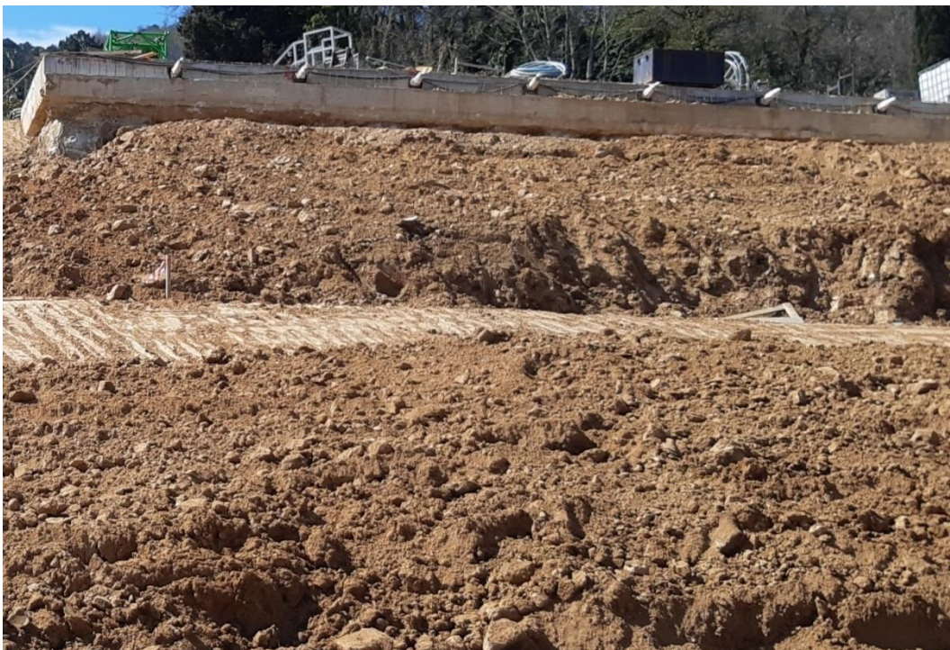
Figura 18 Taglio di versante alla base dei rilievi in località Piscinale, sotto la paratia di monte, in posizione (circa) antistante i sondaggi MC51_N2 e T1501 (ubicati dietro la paratia ad una distanza di circa 20 m). Aspetto in parete della formazione a3 (foto)
