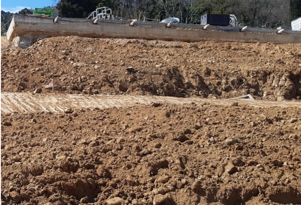
Figura 7-8 – Taglio di versante alla base dei rilievi in località Piscinale, sotto la paratia di monte, in posizione (circa) antistante i sondaggi MC51_N2 e T1501 (ubicati dietro la paratia ad una distanza di circa 20 m). Aspetto in parete della formazione a3 (foto 07/2023).
