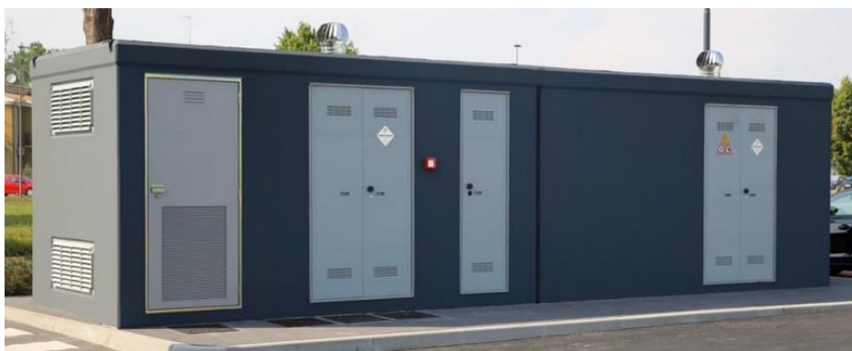
Figura 3.9 – tipologiche cabine elettriche
