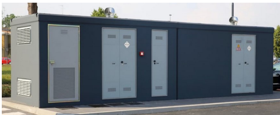
Figura 3.12: tipologie cabine elettriche
