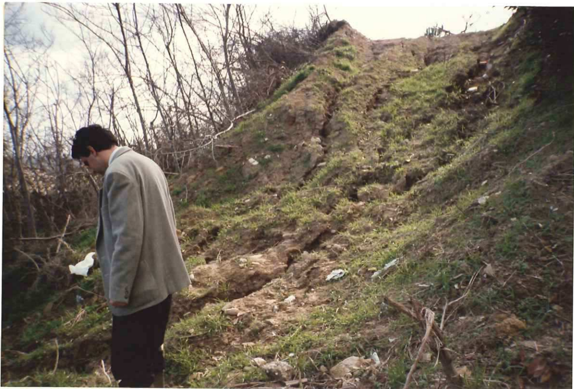
FOTO 3: LESIONE IN ZONA DI CORONAMENTO - SETTORE ORIENTALE (FOTO DEL 7 FEBBRAIO c.a.)
