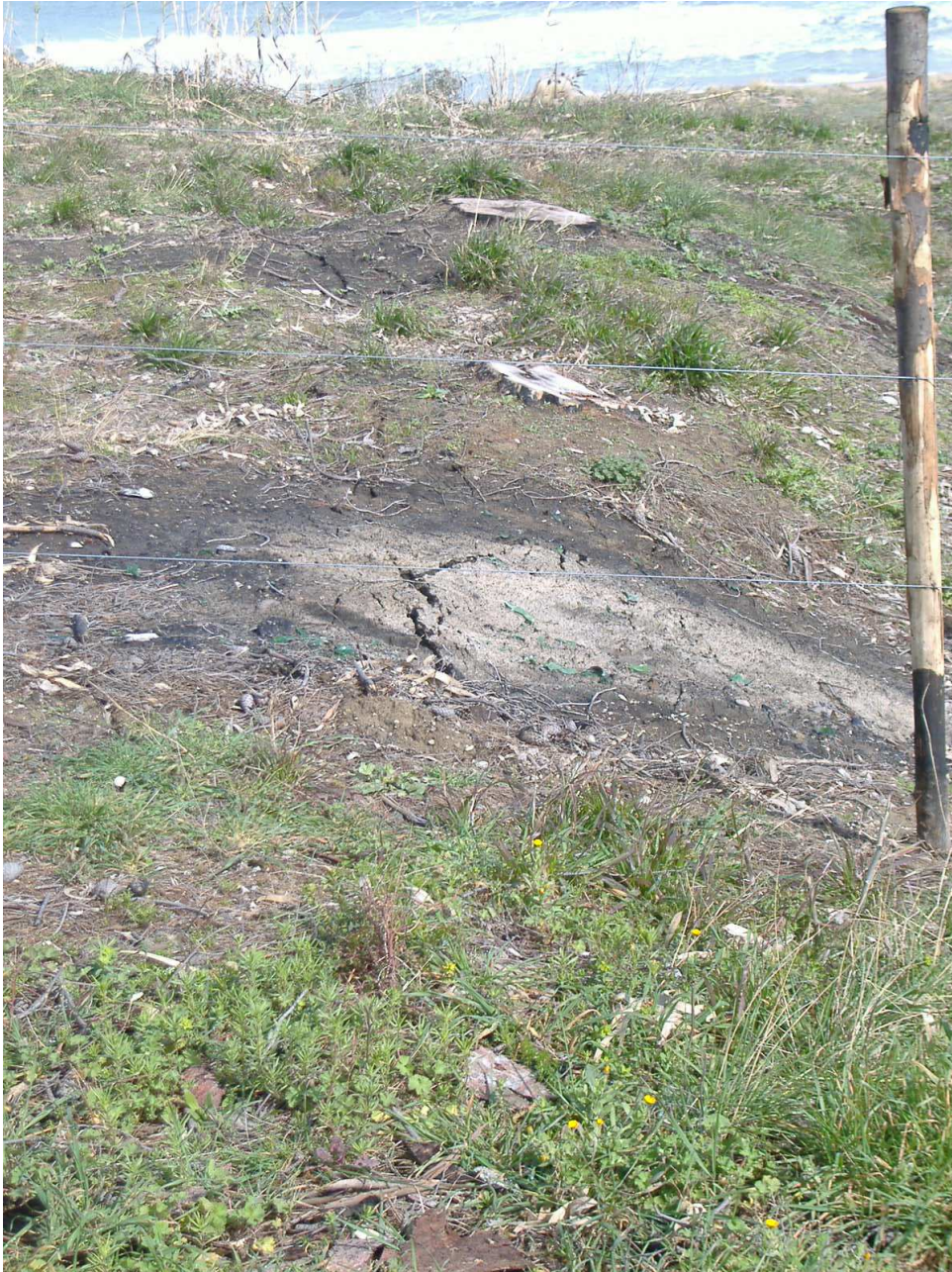
FOTO 23: FRATTURE NEL TERRENO ADIACENTE LA S.S. 16 ADRIATICA
