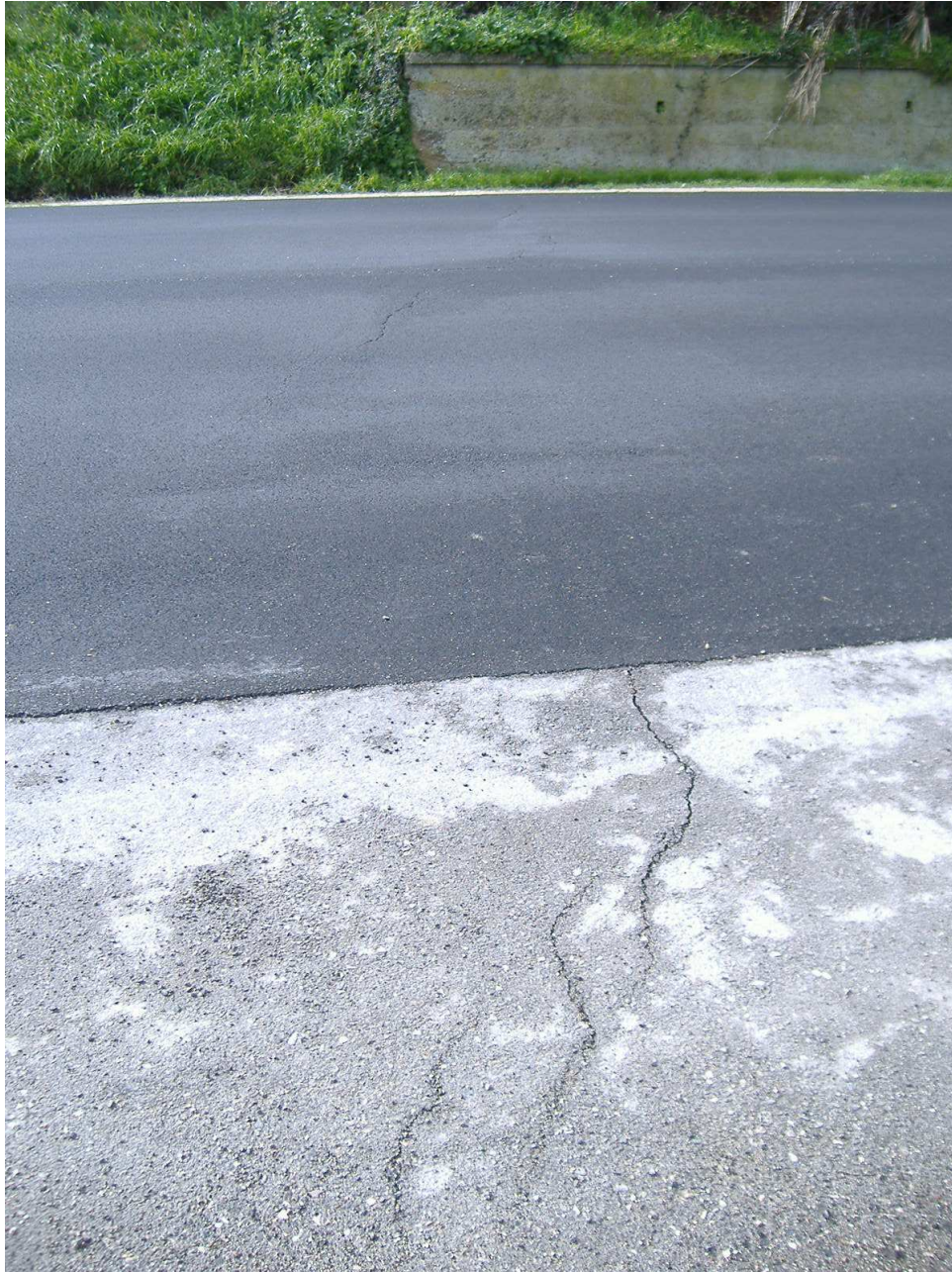
FOTO 27: LOCALITÀ TORRE DI PETACCIATO - FRATTURE NEL MANTO STRADALE DELLA S.S. 16 ADRIATICA
