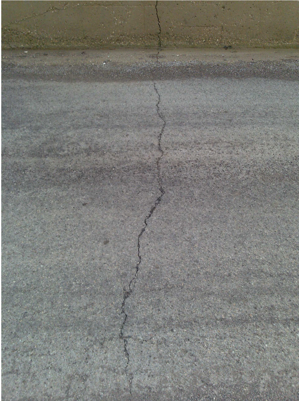
FOTO 28: LOCALITÀ TORRE DI PETACCIATO - FRATTURE NEL MANTO STRADALE DELLA STRADA COMUNALE ADIACENTE LA FERROVIA
