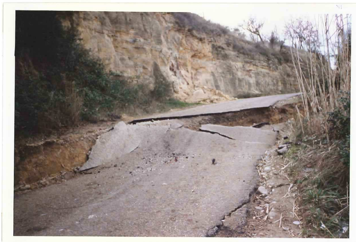
FOTO 6: LOCALITA' CAVA DELLA RIPA - PARTICOLARE STRADA E SMOTTAMENTO FALESIA
