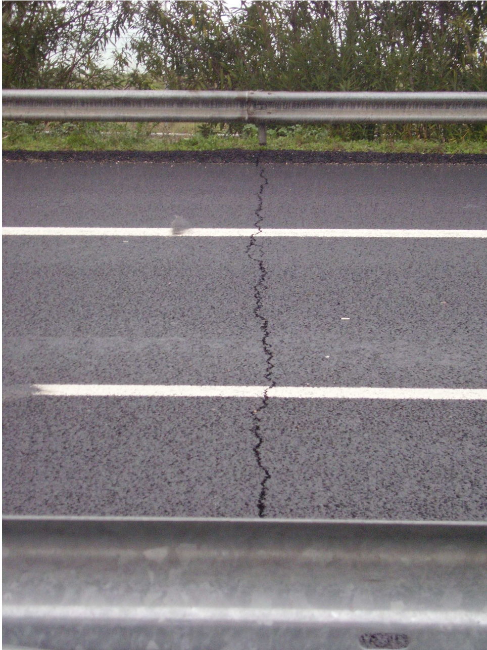
FOTO 22: LESIONE SUL MANTO AUTOSTRADALE IN CARREGGIATA NORD
