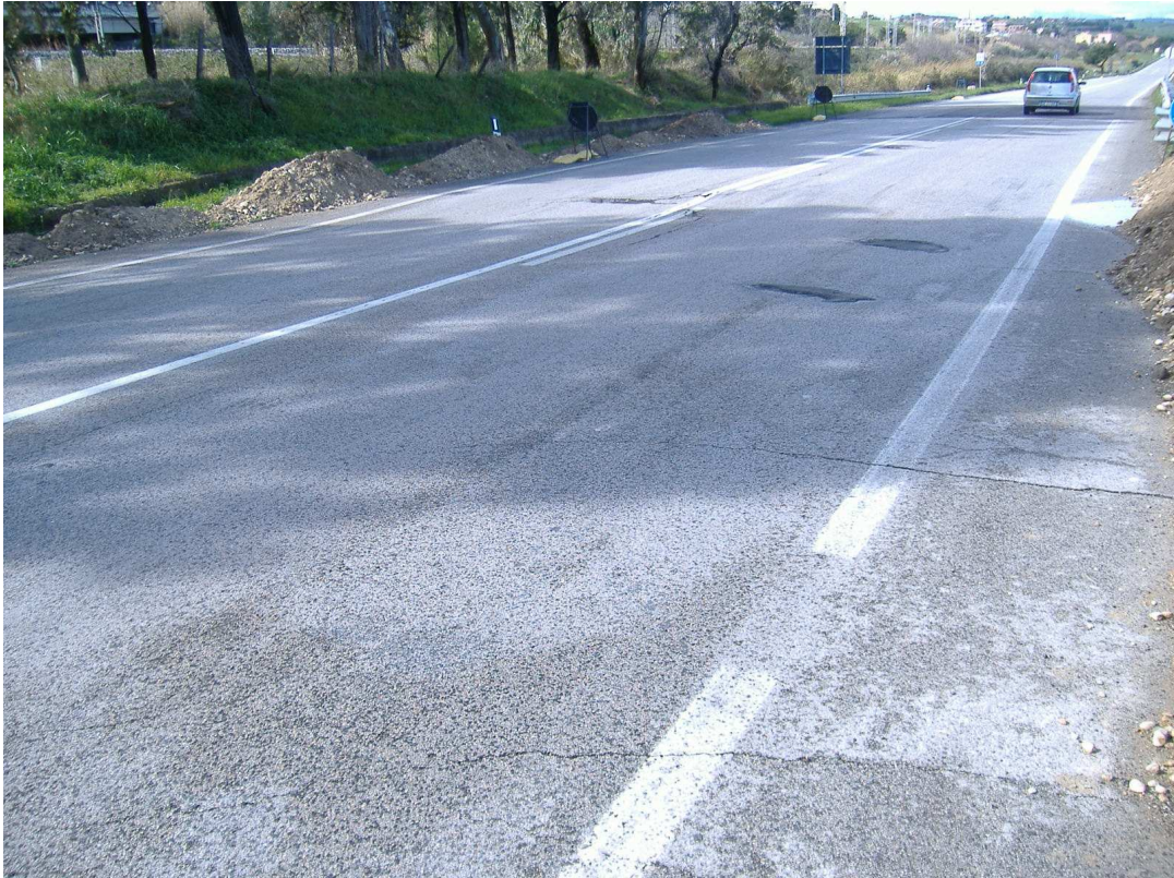
FOTO 25: FRATTURE NEL MANTO STRADALE DELLA S.S. 16 ADRIATICA
