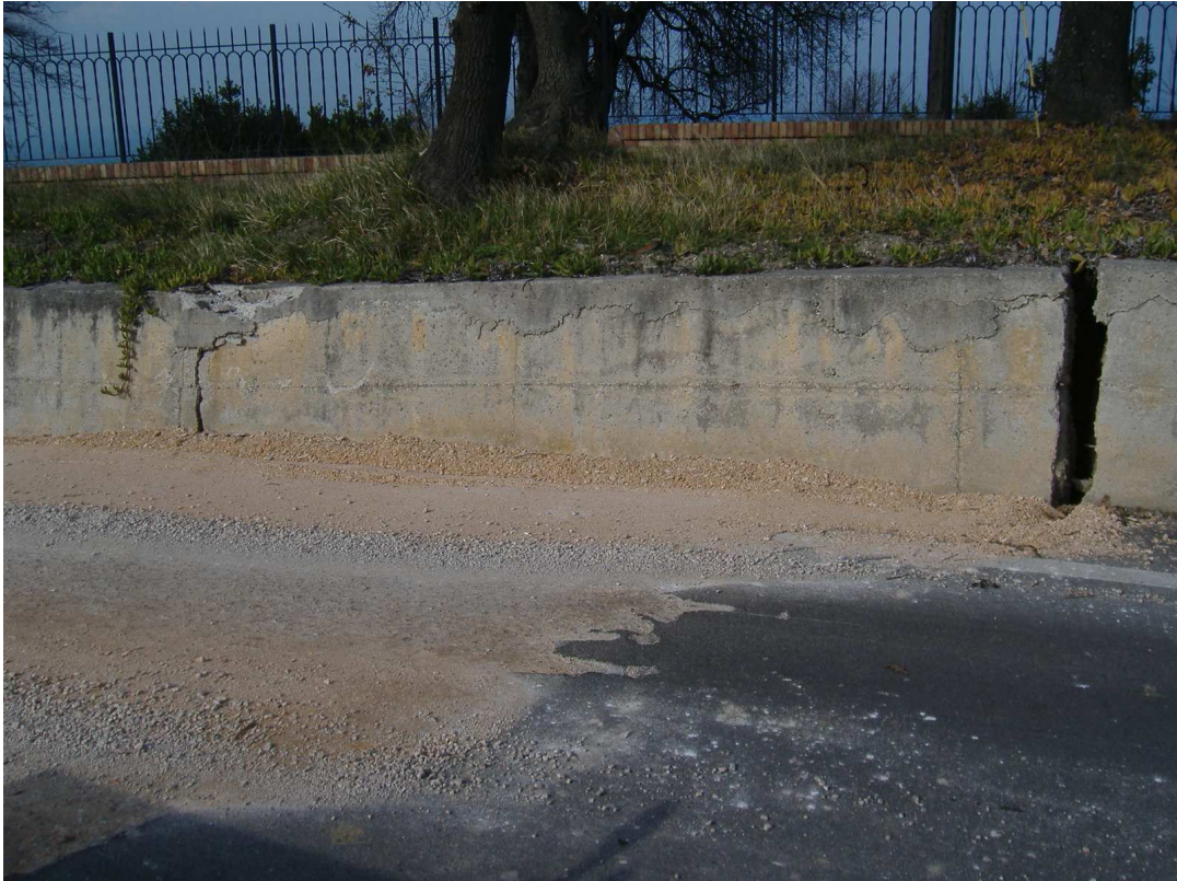
FOTO 10: LA STESSA FESSURA HA INTRESESSATO ANCHE LE ABITAZIONI ADICENTI
