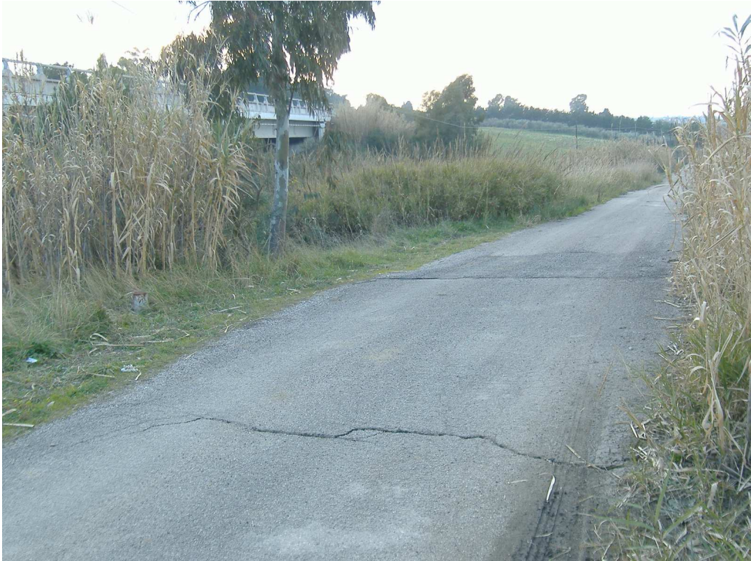
FOTO 20: FRATTURE SULLA STRADA COMUNALE , TRA IL VIADOTTO CACCHIONE E LA FERROVIA
