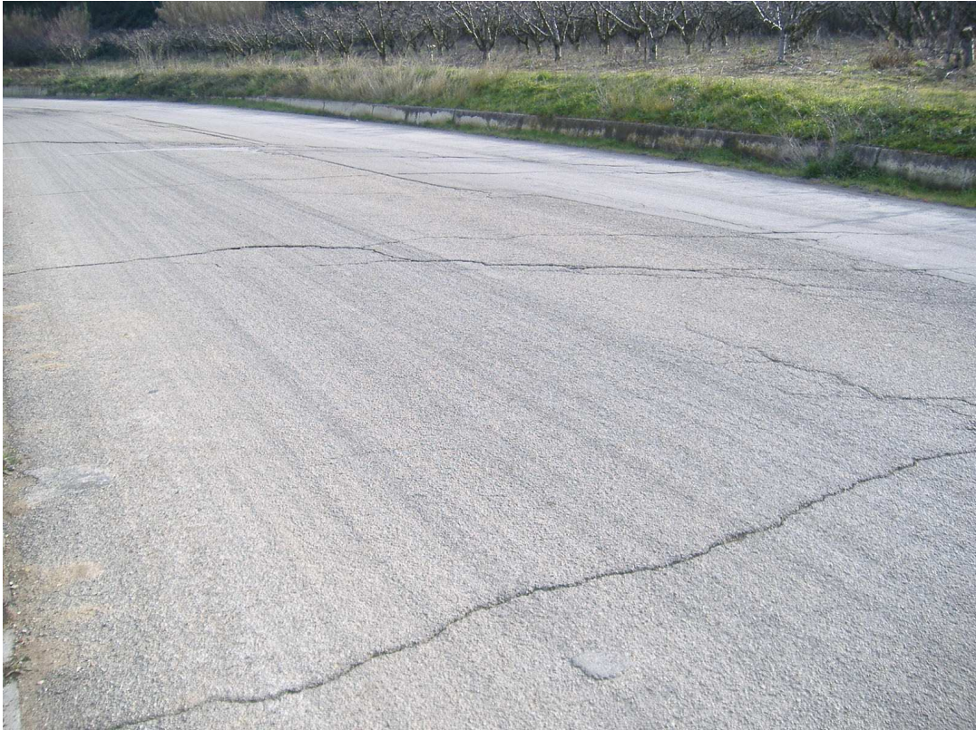
FOTO 13: FRATTURE NEL MANTO STRADALE LA S.P. LITORANEA – DIREZIONE NORD_OVEST
