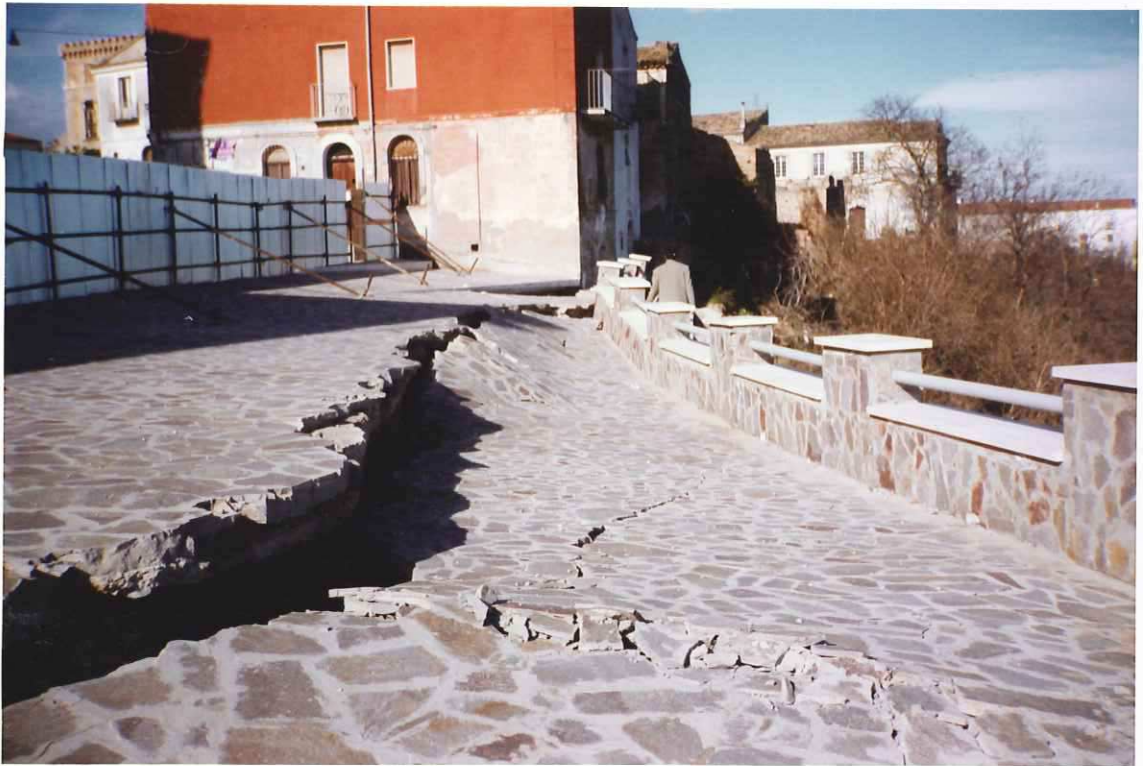
FOTO 1: LESIONE IN ZONA DI CORONAMENTO - PIAZZALE PANORAMICO
