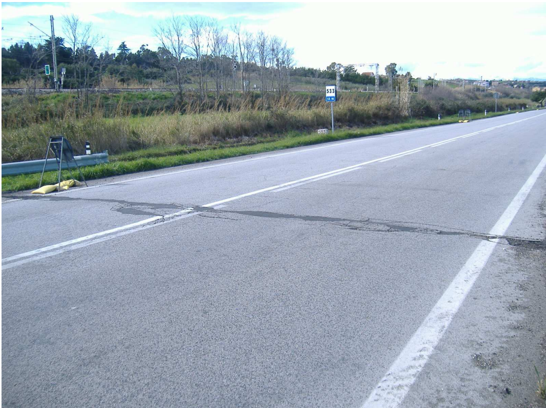
FOTO 26: FRATTURE NEL MANTO STRADALE DELLA S.S. 16 ADRIATICA
