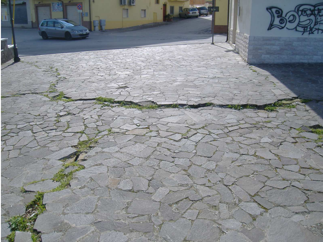
FOTO 4: CONTINUAZIONE VERSO EST DELLE FRATTURE PRECEDENTI
