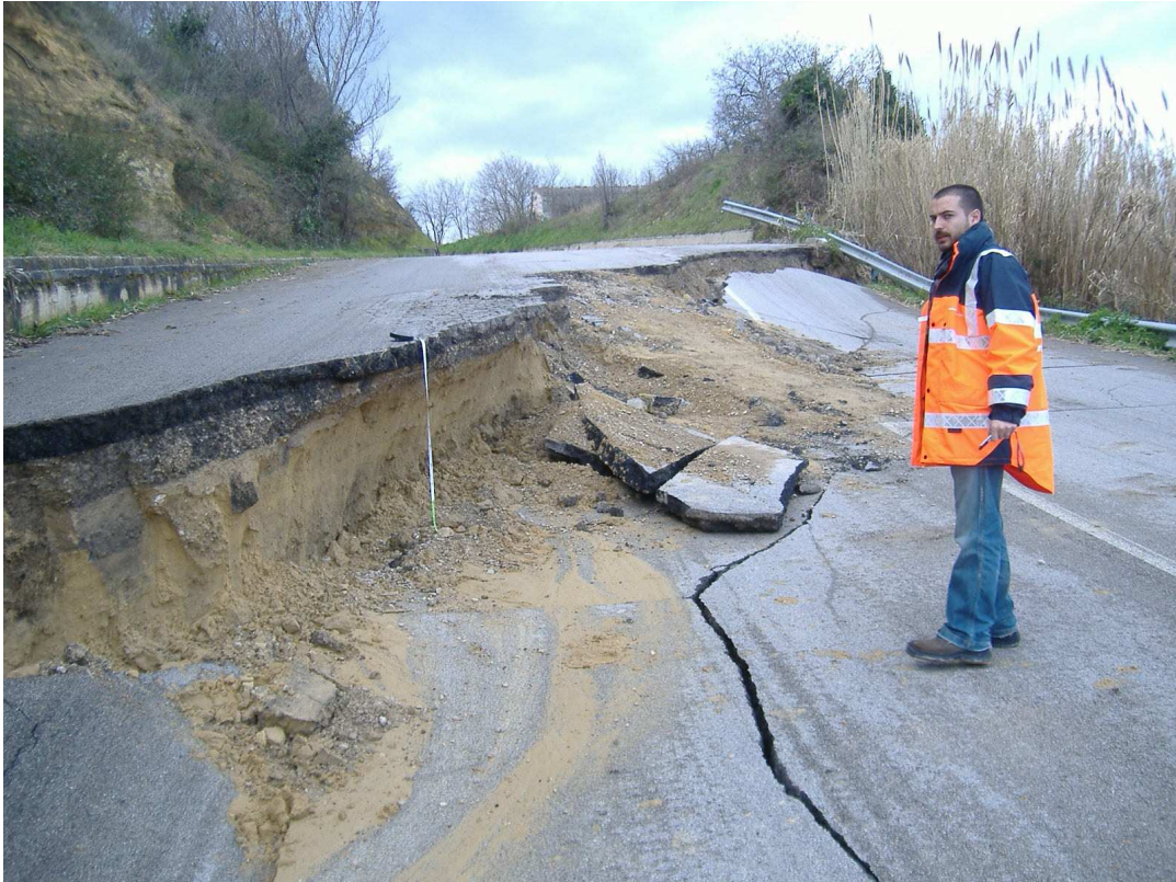
FOTO 6: LOCALITA' CAVA DELLA RIPA – DISLOCAZIONE DELLA STRADA COMUNALE
