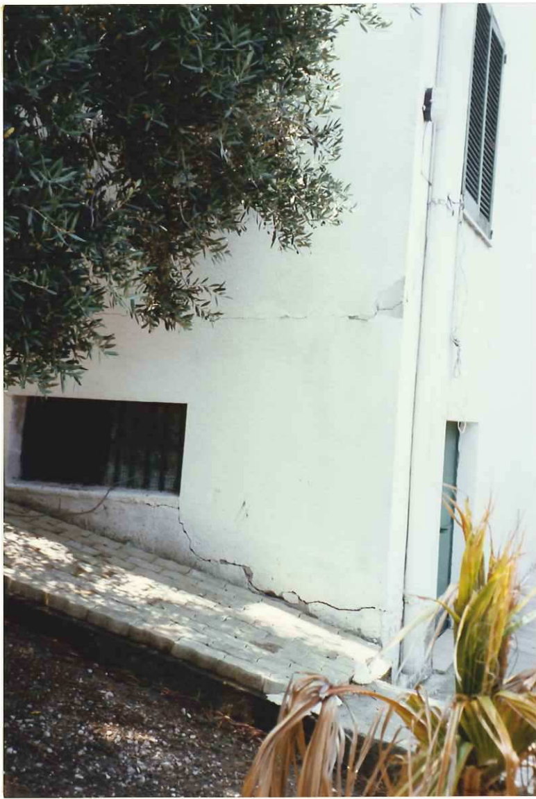
FOTO 11: LOC. COLLE DEGLI ULIVI - CEDIMENTI PREMONITORI AL FRANAMENTO
