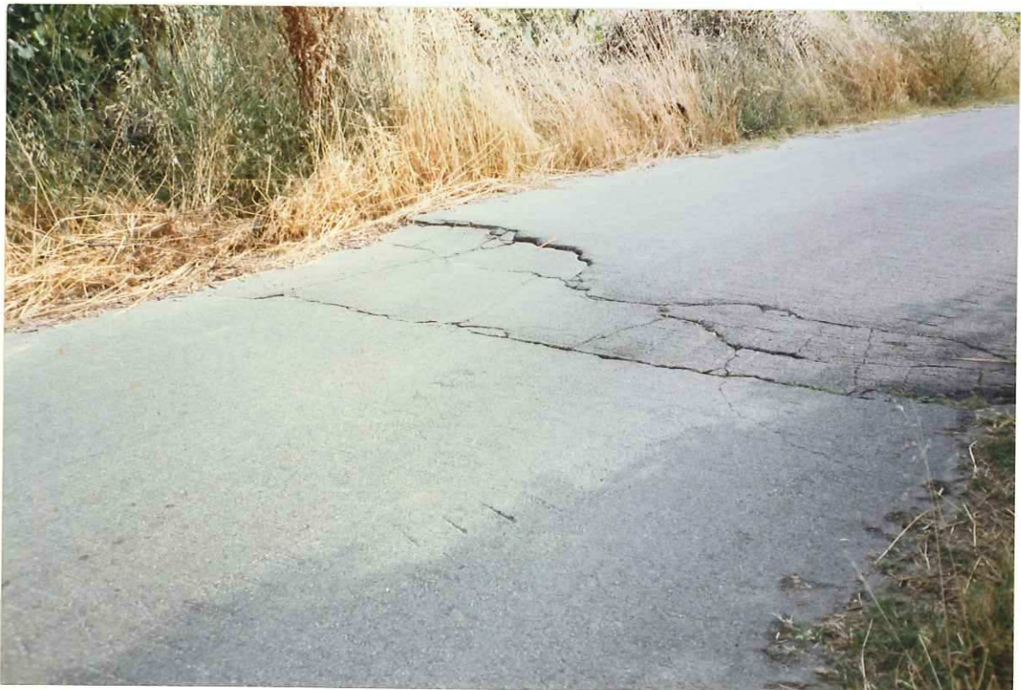
FOTO 12: STRADA VICINALE LOC. COLLE DEGLI ULIVI - ZONA DI ATTRAVERSAMENTO LESIONE PRINCIPALE
