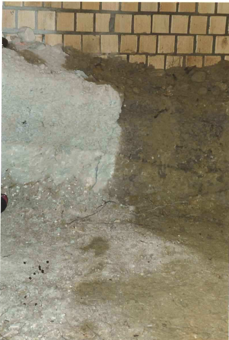
FOTO 10: LOC. FONTE RAVANELLI - LESIONE IN COSTRUZIONE ACCESSORIA - PART. DELLE FONDAZIONI
