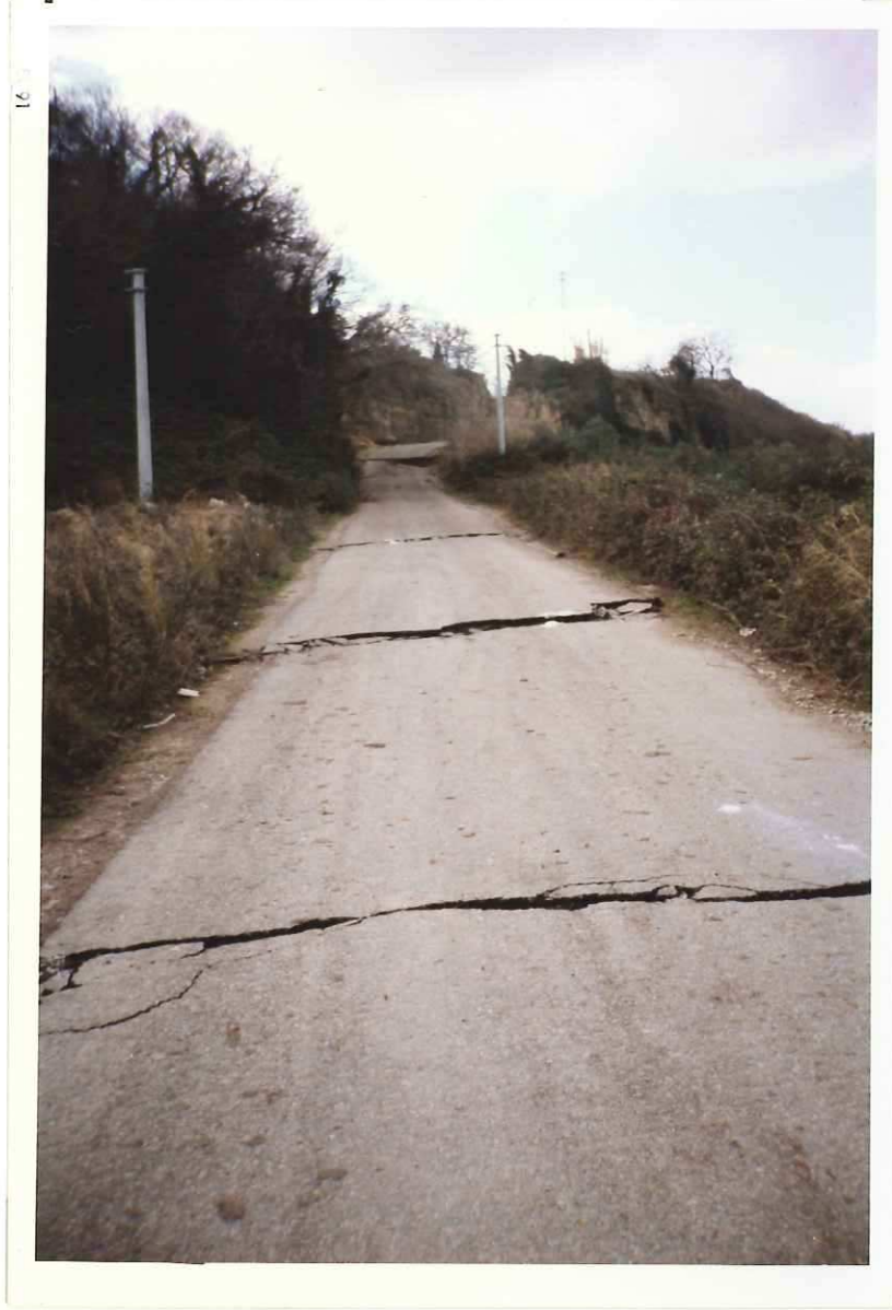
FOTO 5: LOCALITA' CAVA DELLA RIPA - FRATTURA SULLA STRADA
