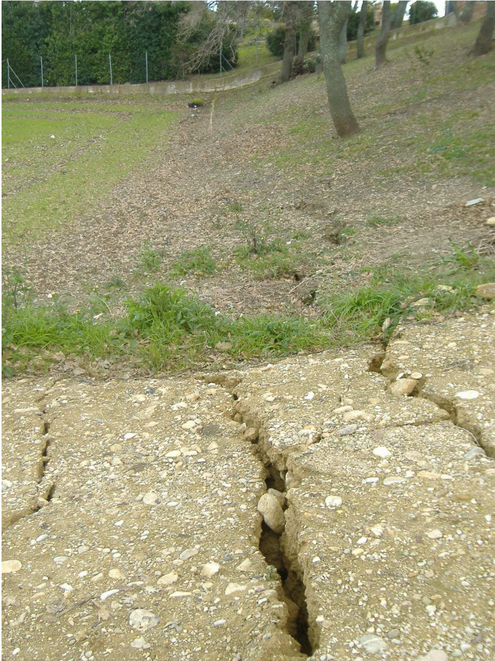
FOTO 12: FRATTURE NEI TERRENI ADICENTI LA S.P. LITORANEA – DIREZIONE OVEST
