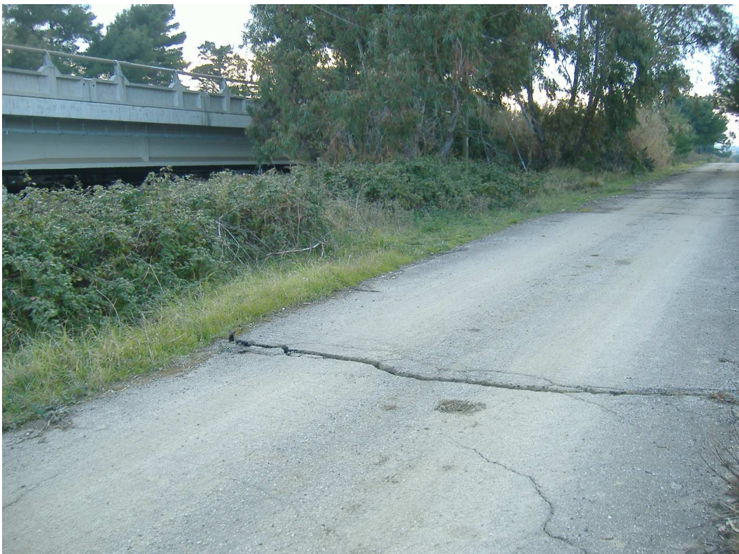
FOTO 19:FRATTURE SULLA STRADA COMUNALE , TRA IL VIADOTTO MARINELLA E LA FERROVIA
