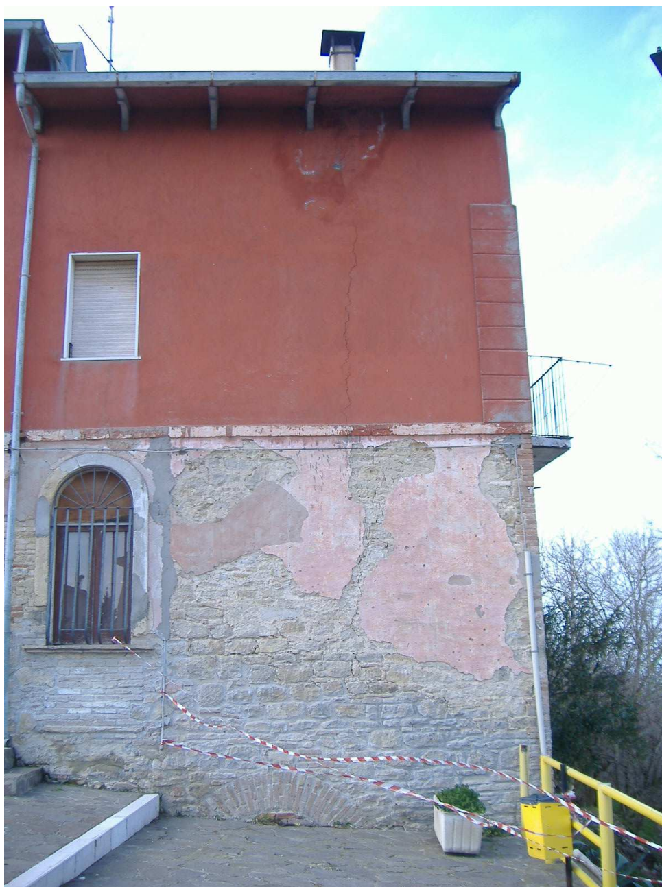
FOTO 3: LESIONI ALLE STRUTTURE MURARIE DI ABITAZIONI PROSSIME AL PIAZZALE
