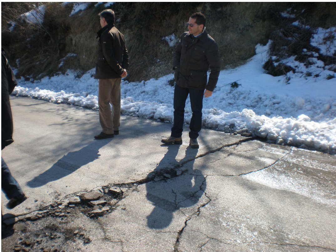
FOTO 17: FRATTURE NEL MANTO STRDALE DELA S.P. DI PETACCIATO
