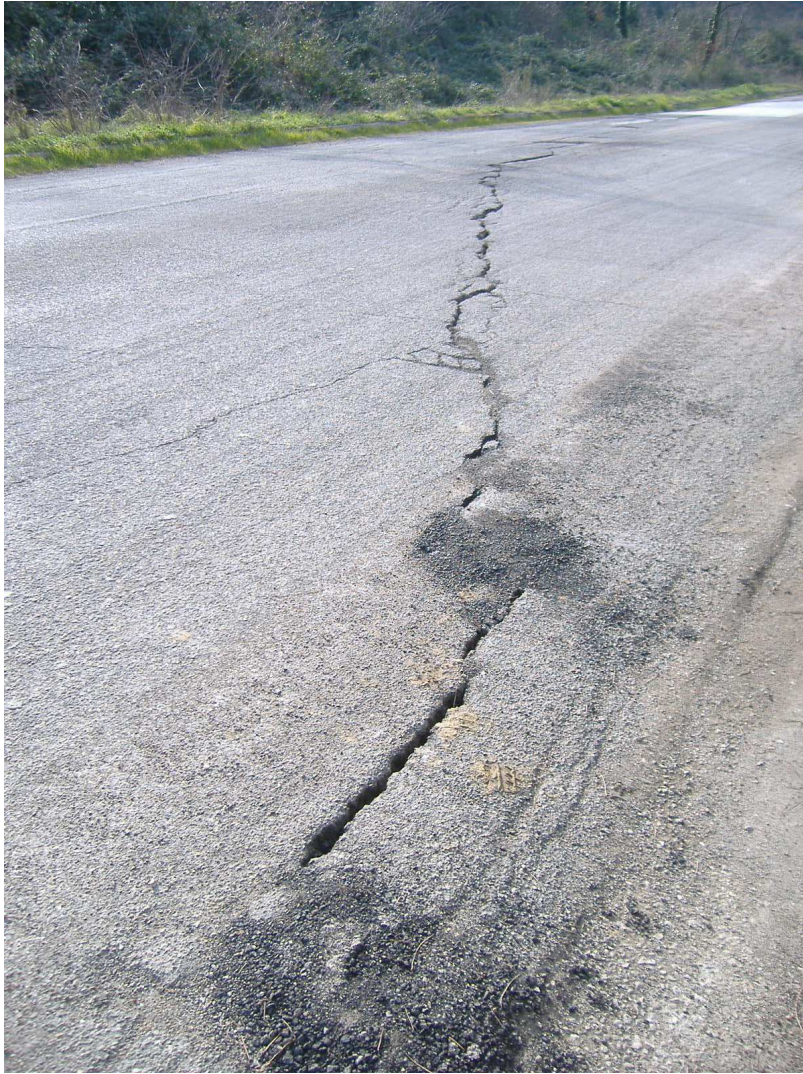
FOTO 11: FRATTURA NEL MANTO STRADALE DELLA S.P. LITORANEA
