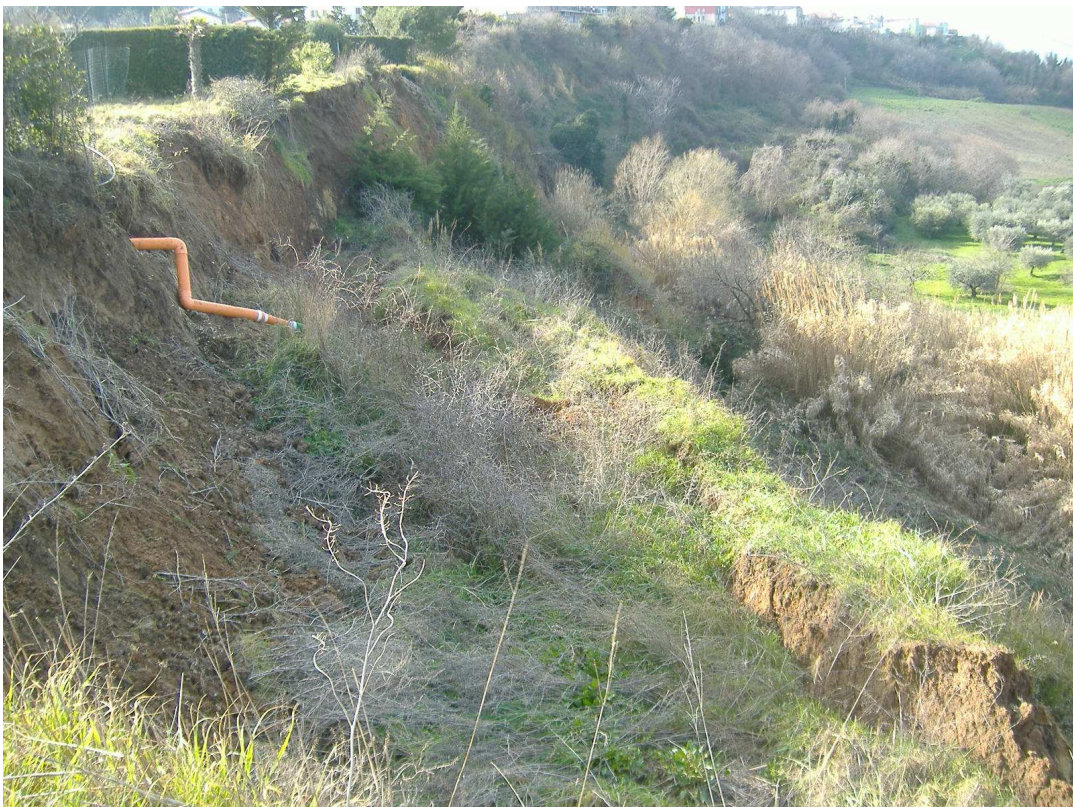
FOTO 7: LOCALITÀ CAVA DELLA RIPA – TERRAZZAMENTI LUNGO IL FRONTE DI FRANA
