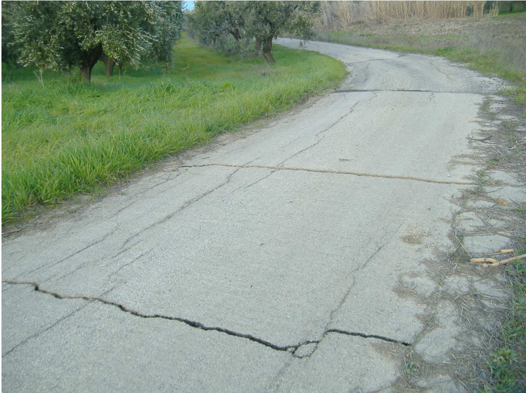
FOTO 18: FRATTURE SULLA STRADA COMUNALE CHE SCENDE A MARE
