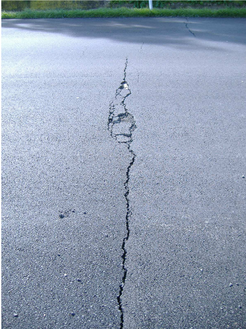
FOTO 24: FRATTURE NEL MANTO STRADALE DELLA S.S. 16 ADRIATICA
