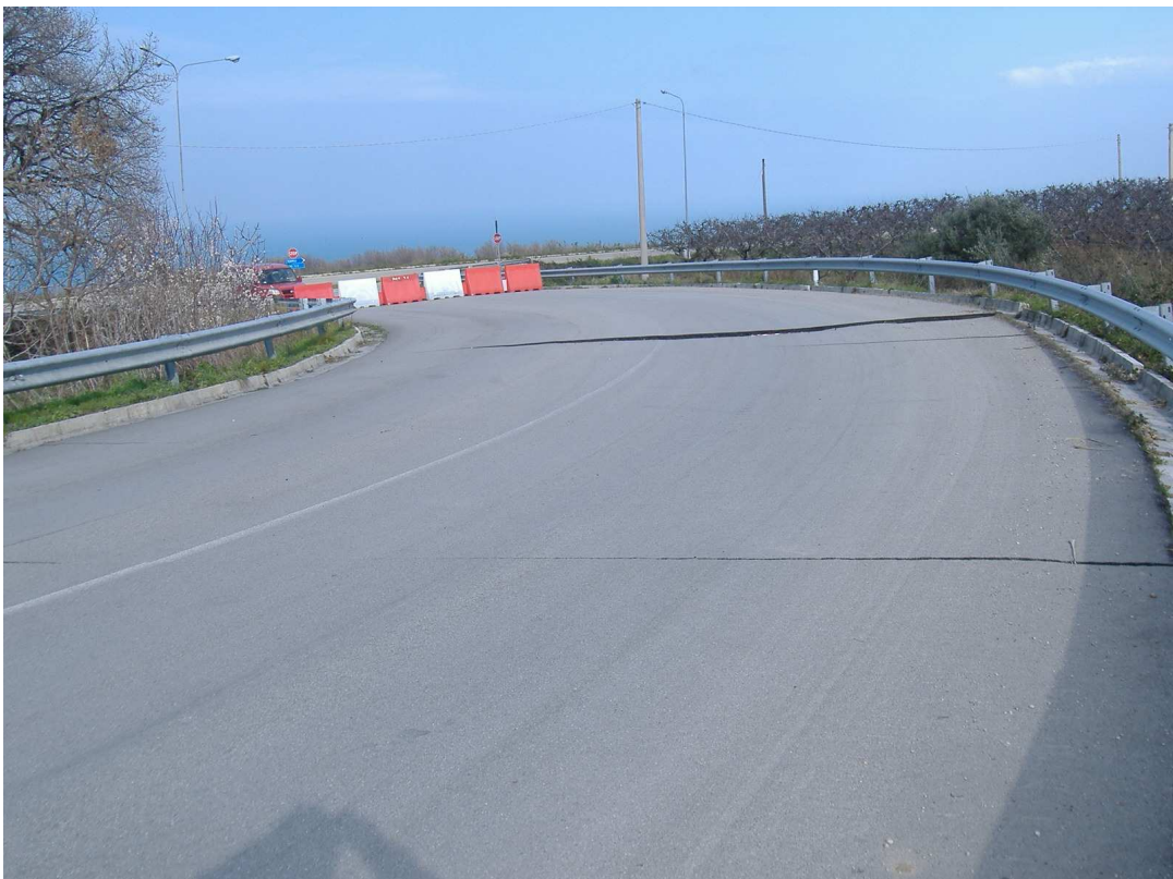
FOTO 14: FRATTURE NEL MANTO STRADALE LA S.P. LITORANEA – DIREZIONE NORD_OVEST
