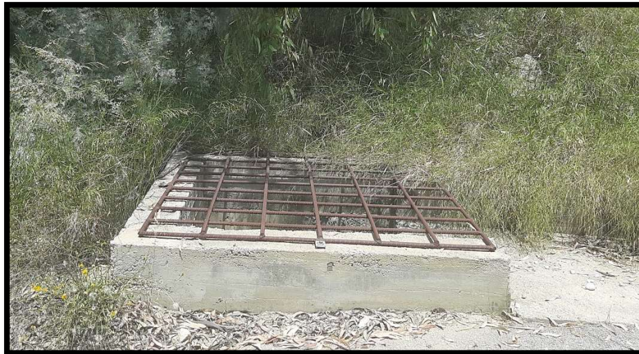
Figura 49 - foto dell'impianto costituente l'interferenza "Int.55"
