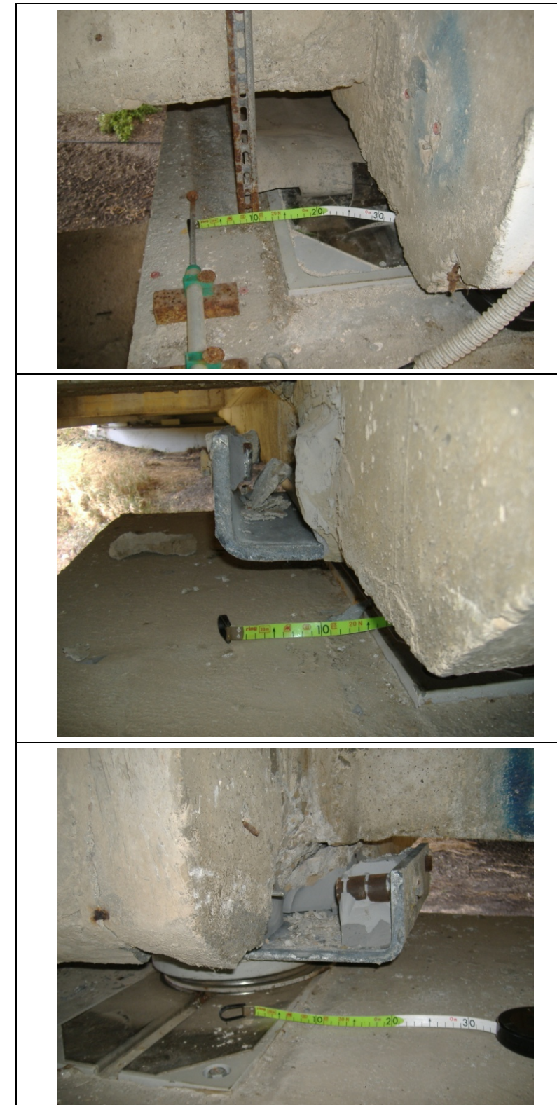
Figura 3-14: Evidenza dei danni subiti dalla struttura del viadotto Cacchione a seguito della riattivazione del movimento franoso di febbraio 2009
