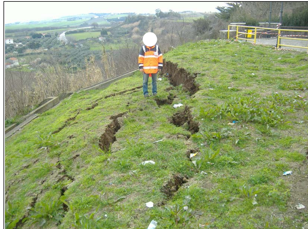
Figura 3-13: Evidenza geomorfologica in corrispondenza della zona dell'abitato di Petacciato a seguito della riattivazione del movimento franoso di febbraio 2009
