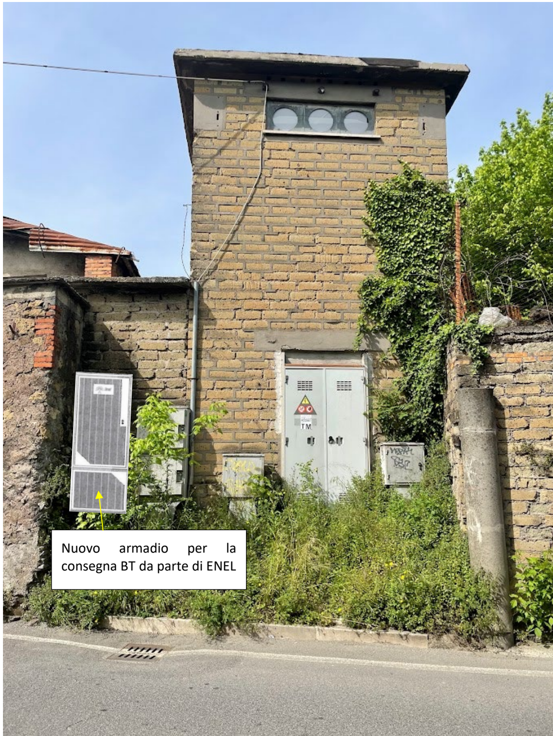
Foto 4.9 – Cabina ENEL presente su via Acquaregna. L'armadietto di consegna su indicazione di ENEL verrà realizzato sul muro di proprietà di ENEL a fianco della cabina.
