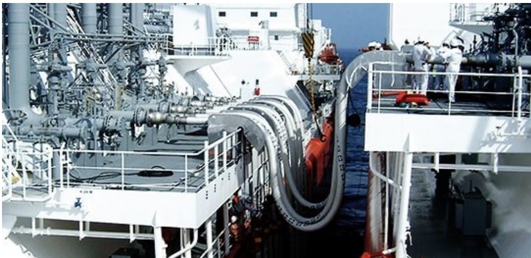
Figura 29 – Tipico collegamento STS per trasferimento GNL
