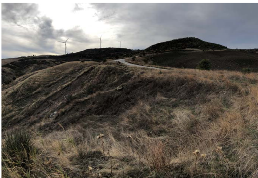
Foto 3-14 – Fenomeni gravitativi attivi agenti lungo il versante interessato dall’opera del Viadotto Cerro e nello specifico dalla Spalla Nord.
