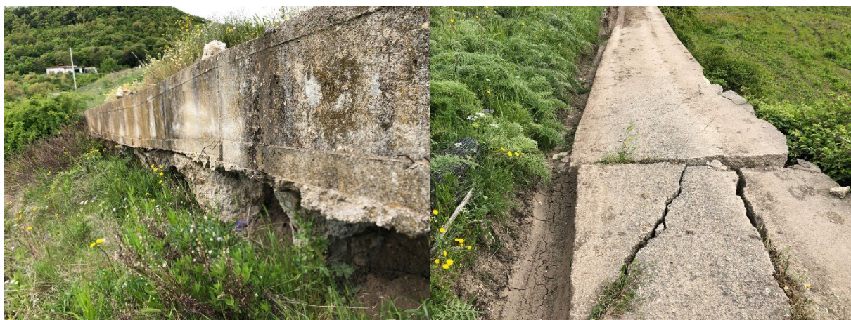
Figura 2.35 – – Disarticolazione del corpo della paratia posta esistente ubicata a protezione della strada ad indicare l'attività del movimento franoso considerato.
