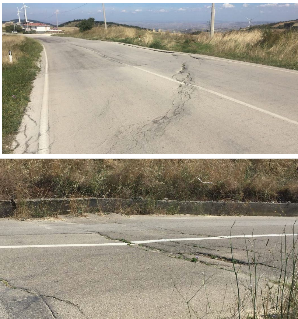
Figura 2-2: vista dell'itinerario attuale per il collegamento tra la SS407 e la SS96 – Ammaloramenti lungo la strada comunale Pazzano – Tre Ponti
