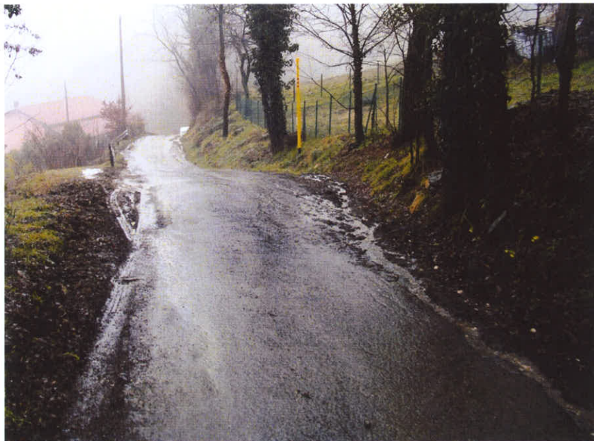
Figura 3-2: area “Roncaglie”, diffusa presenza di acqua lungo le cunette stradali.
