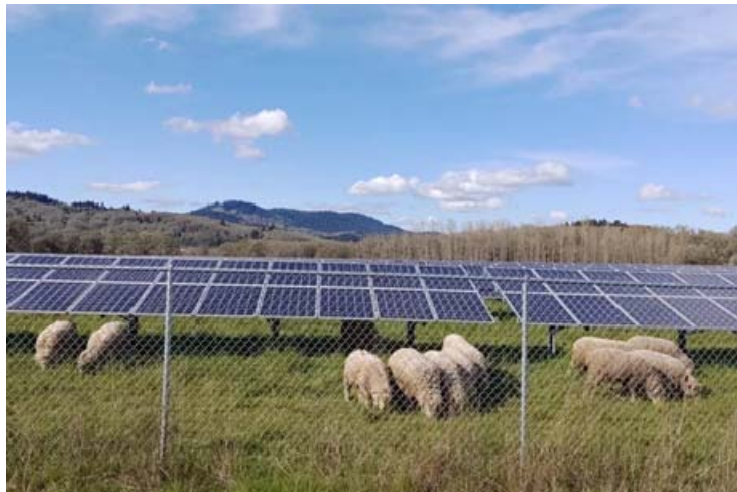
Esempio di posa inseguitore monoassiale a 2 moduli in verticale, con allevamento pecore e recinzione tipica interna a progetto
