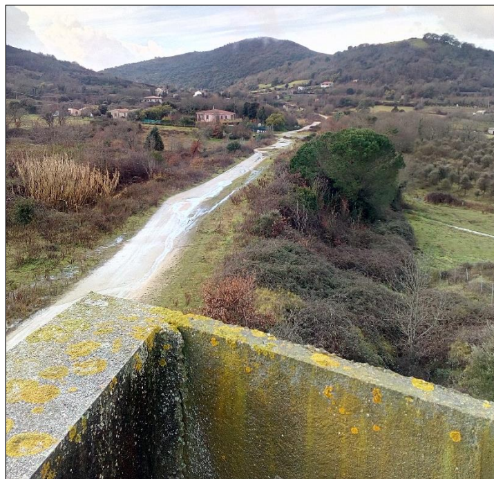
Fig. 5.9 – Rilevato stradale esistente tra lo svincolo e l’imbocco nord della galleria, entrambi non completati, e relativi al lotto precedente della nuova S.S. 127 “Settentrionale Sarda”.
