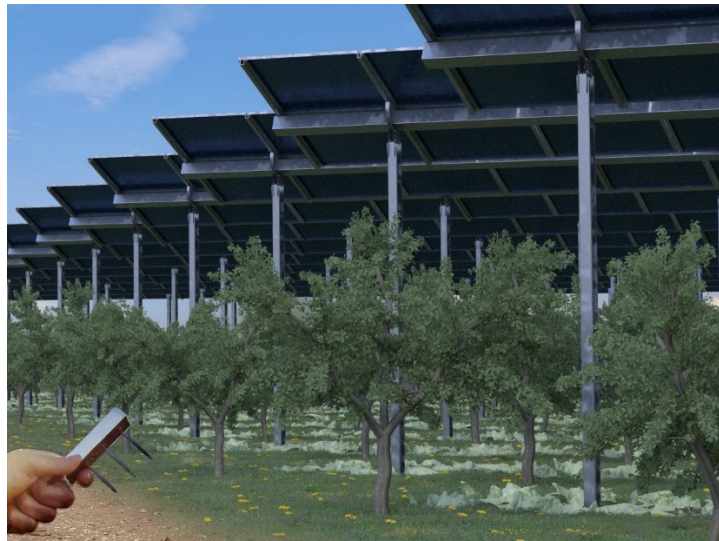
Figura 47 – Esempio di Sensore TEROS12 (Meter) da inserire per il monitoraggio delle colture impiantate tra le interfile dei tracker
