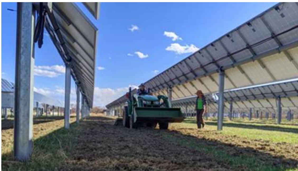
Figura 1: Foto raffigurante la tecnologia di installazione dell'impianto agrivoltaico
