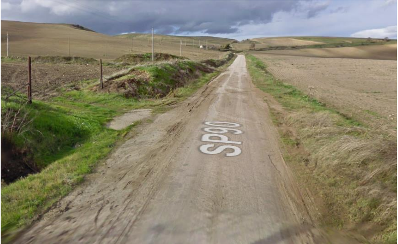
Fig. 12 – Degrado dei canali idraulici lungo la SP 90
