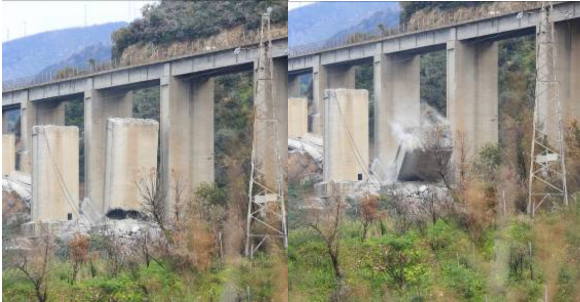
Figura 13: esempio di una pila demolita per crollo indotto (foto archivio General Smontaggi)
