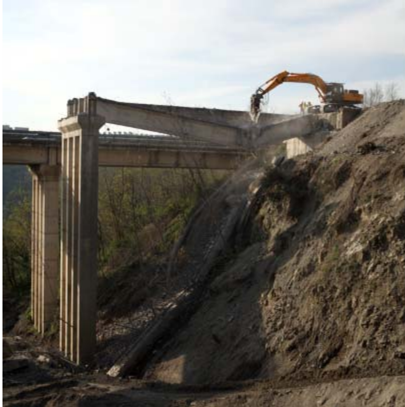
Figura 9: esempio di una trave demolita per crollo (foto archivio General Smontaggi)
