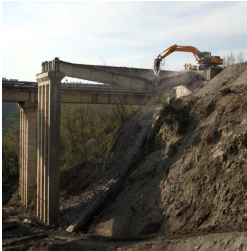
Figura 10: esempio di una trave demolita per crollo (foto archivio General Smontaggi)
